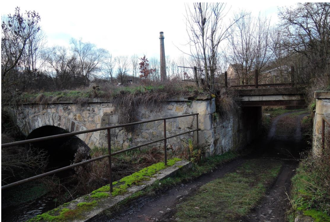
dvojice mostů v ev. km 17,364 a 17,380 určených k rozšíření (na opačnou stranu) ve variantě Týnec
