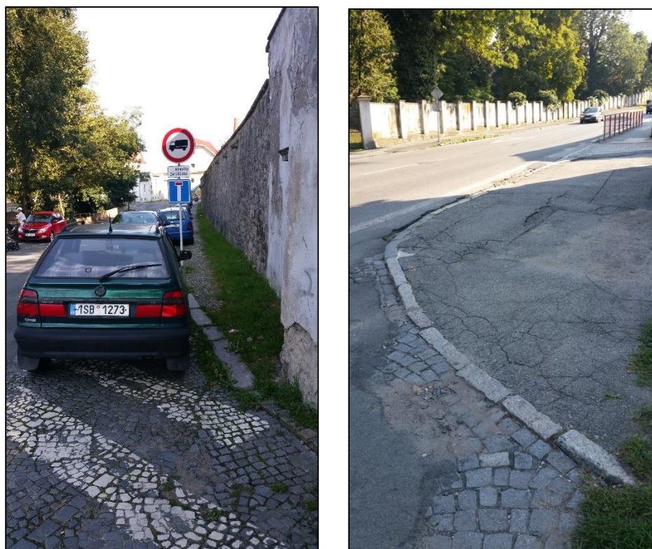
Obr. 26 – Podélné parkování v ul. Na Celné a rozpadající se chodník s krajnicí vozovky na výjezdu z ul. Na Prádle
