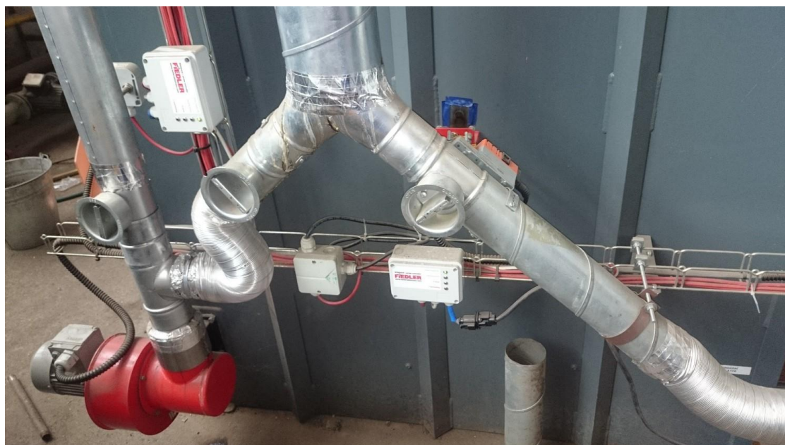
Obr. 14 - Rozdělení recirkulačního potrubí do primárního a sekundárního přívodu
