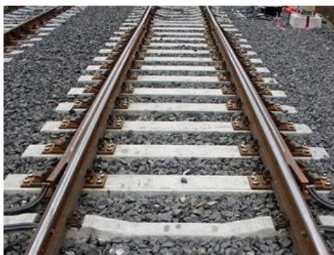
Obrázek 7: Malé dilatační kolejové zařízení
