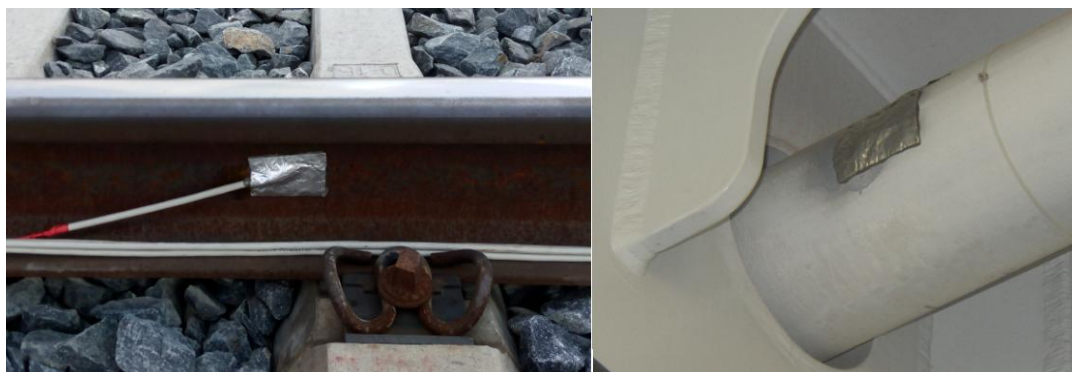
Obrázek 30: Umístění tenzometrů do těžiště měřeného prvku, vlevo: kolejnice, vpravo: kotevní tyč SŘDM
