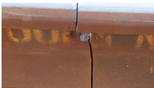
Obrázek 2: Trhlina kolejnice způsobená mrazem
