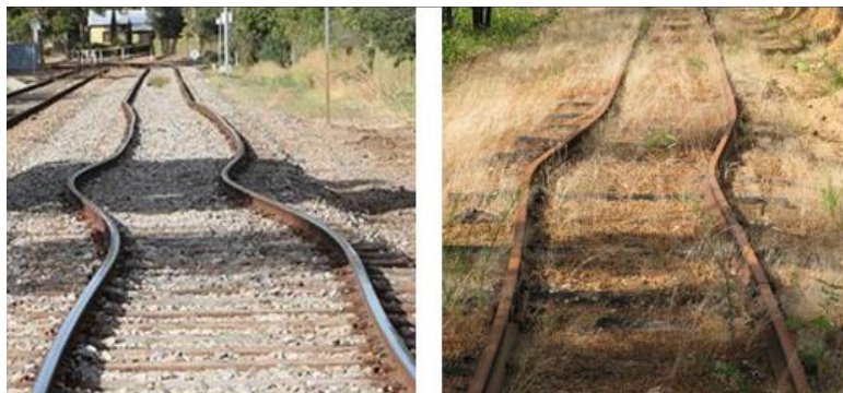
Obrázek 1: Vybočení bezстыkové koleje v důsledku nadměrného tepelného namáhání
