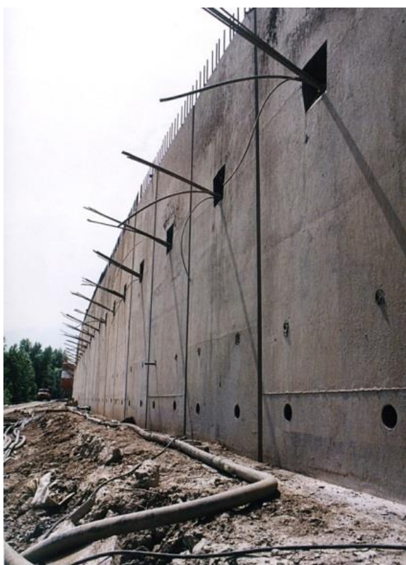
Obr. 2.29 Pohled na odkrytou prefabrikovanou podzemní stěnu, kotvenou v jedné úrovni (Zakládání staveb, a. s., 2016)
