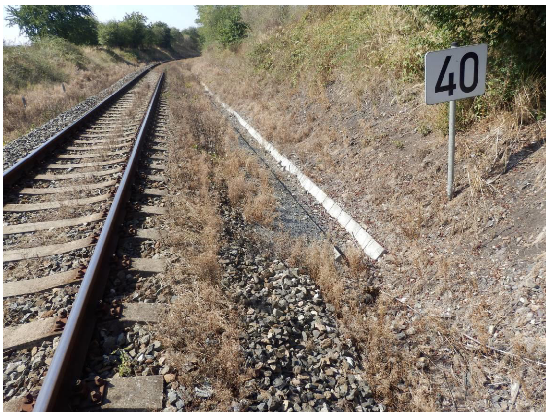
Obr. 22 Zarůstající železniční svršek a zanesený odvodňovací příkop, km 17,900
