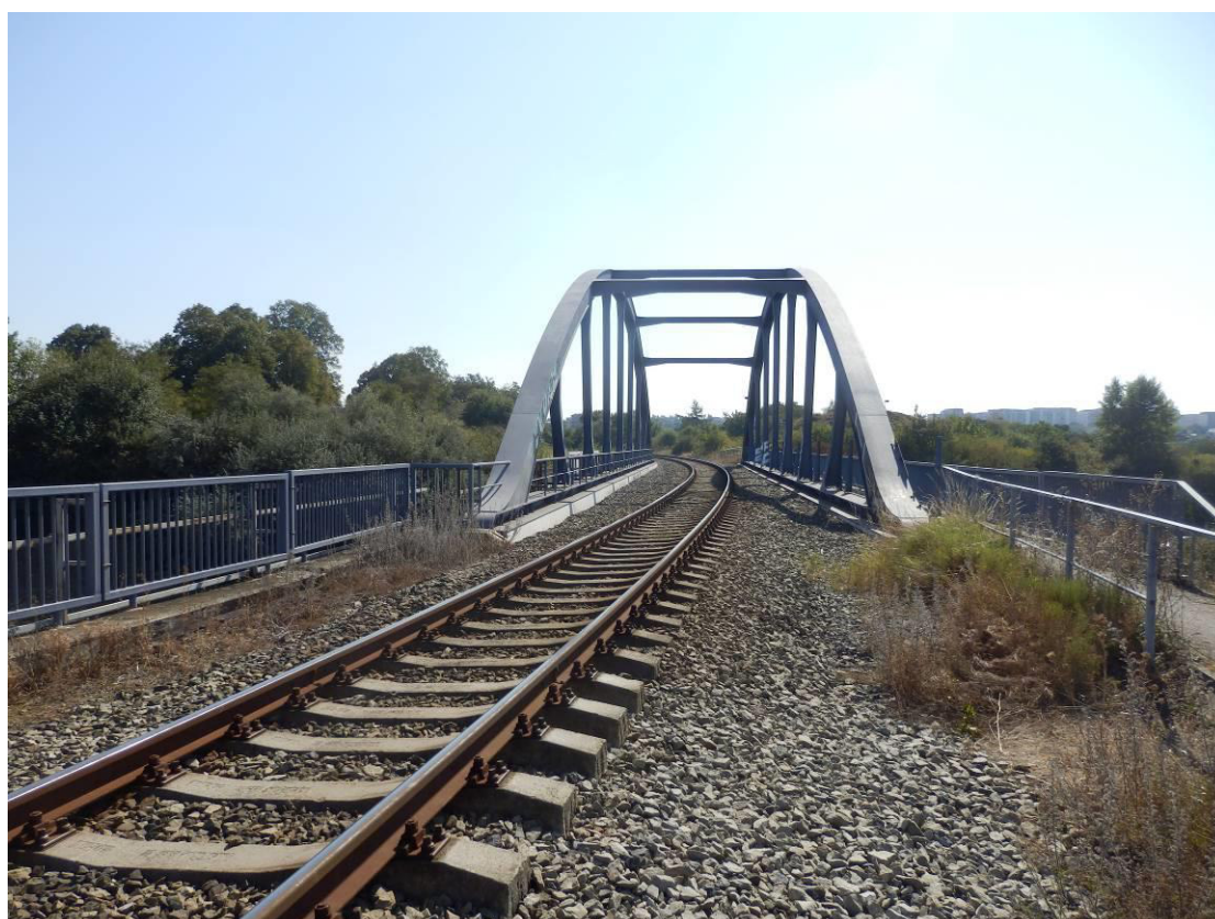
Obr. 20 Obloukový most přes Pražský okruh a nevhovující tvar kolejového lože, km 16,600
