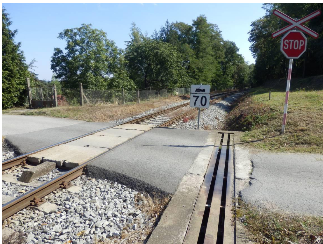
Obr. 18 Přejezd P2196, km 13,546, nedostatečné rozhledové poměry, traťová rychlost snížena na 30 km/h
