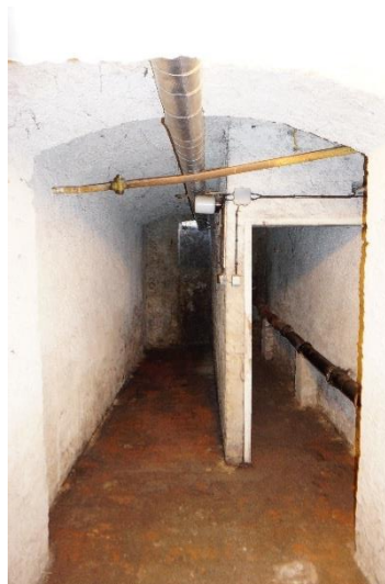
Obr. 43: Jedna z prostředních místností s vedoucí kanalizací
