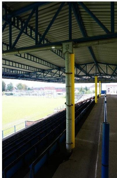
Obr. 67: Dešťový svod, pod betonovým okrajem by mohla být umístěna svodná trubka do AN
