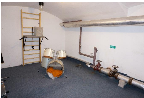
Obr. 39: Místnost s hlavním uzávěrem pitné vody
