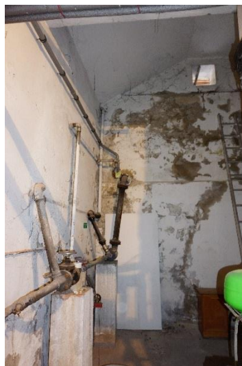
Obr. 63: Místnost s uzávěrem pitné vody umístěným po levé straně
