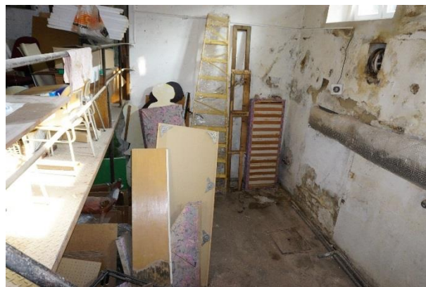
Obr. 24: Dílna školníka, pod poklopem v podlaze je nutno odčerpávat podzemní vody
