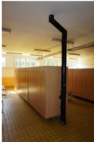
Obr. 29: Viditelný dešťový svod v šatnách
