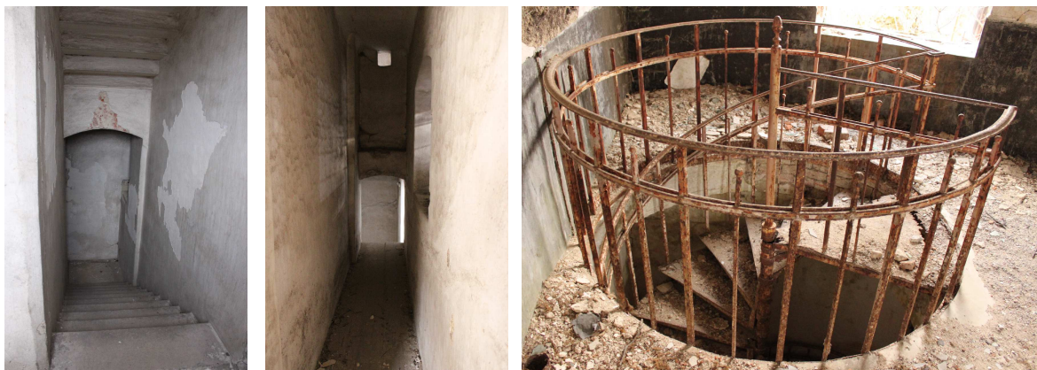
Obr. 24 Schodiště - kamenné schodiště ve schodišťové věži (vlevo a uprostřed), železné točité schodiště v přístavku při sýpce v severozápadní části budovy č. 19 (vpravo); zdroj vlastní
