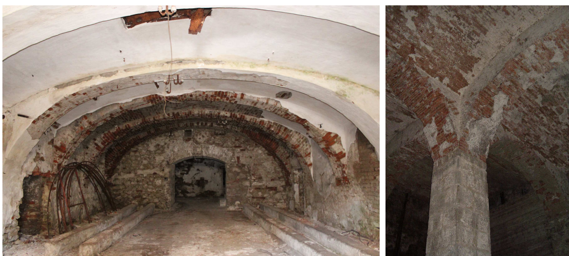
Obr. 25 Pruská klenba v jednom ze sklepů (vlevo), zastropení sladovny (vpravo); zdroj vlastní
