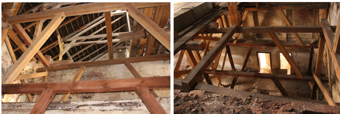
Obr. 27 Pohled do míst někdejších stropních konstrukcí, které se propadly v severovýchodní části pivovaru; zdroj vlastní
