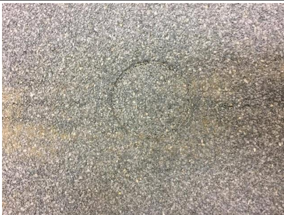
Obr. č. 28: Poškození asfaltového pásu bodovým zatěžováním
