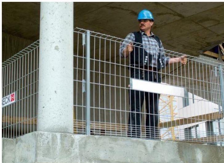
Obr. 22, Zábradlí proti pádu z výšky, zdroj: scaservr.cz
