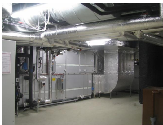
Obr. 17 - pohled na největší vzt jednotku budovy
