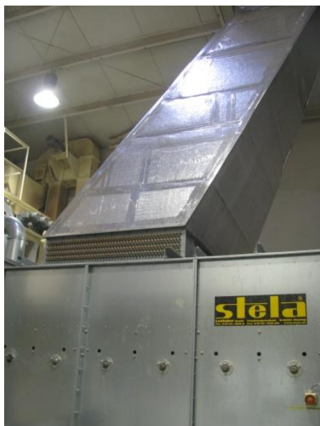
Obr. 18 - pohled na teplovodní výměník
