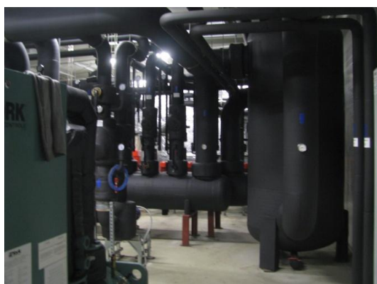
Obr. 16 - pohled do technické místnosti chlazení
