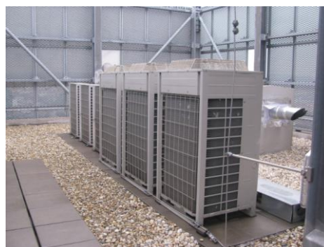
Obr. 13 - VRV jednotky na střeše
