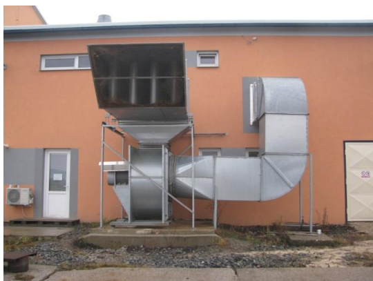
Obr. 20- pohled na vývod odpadního vzduchu pozn.: foto autor
