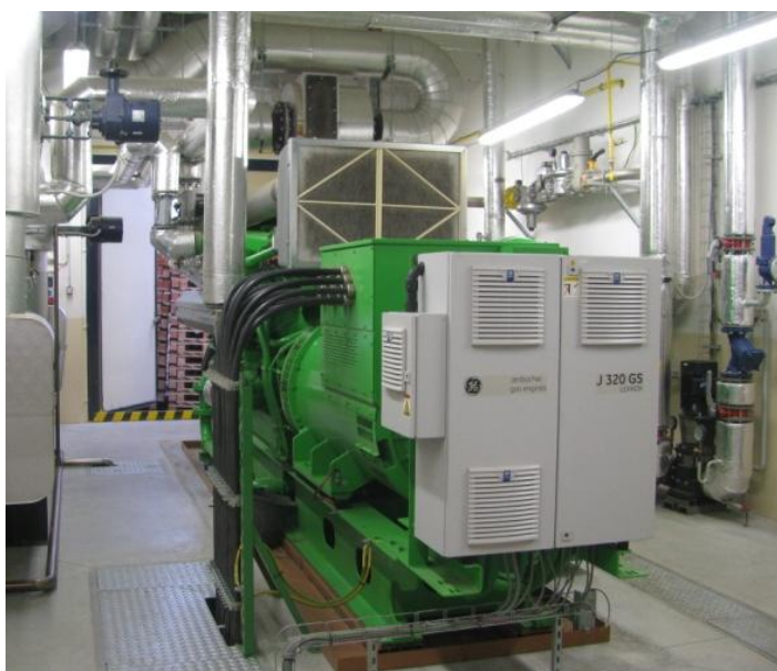
Obr. 19 - pohled na kogenerační jednotku
