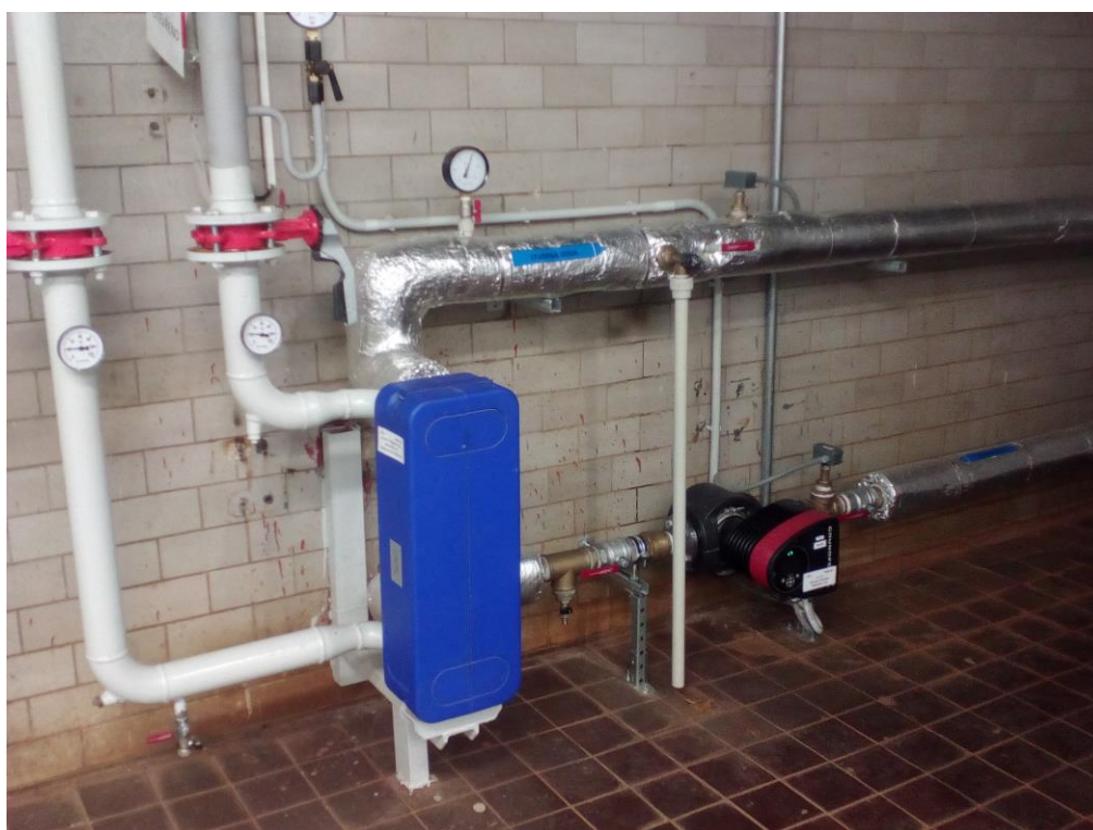
Obrázek 3-9 - Deskový výměník TO KGJ a čerpadlo na straně TUV
