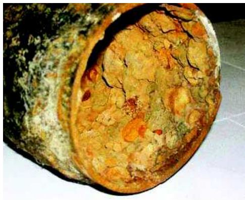
Obrázek 4 - Typické závady potrubí (7)
