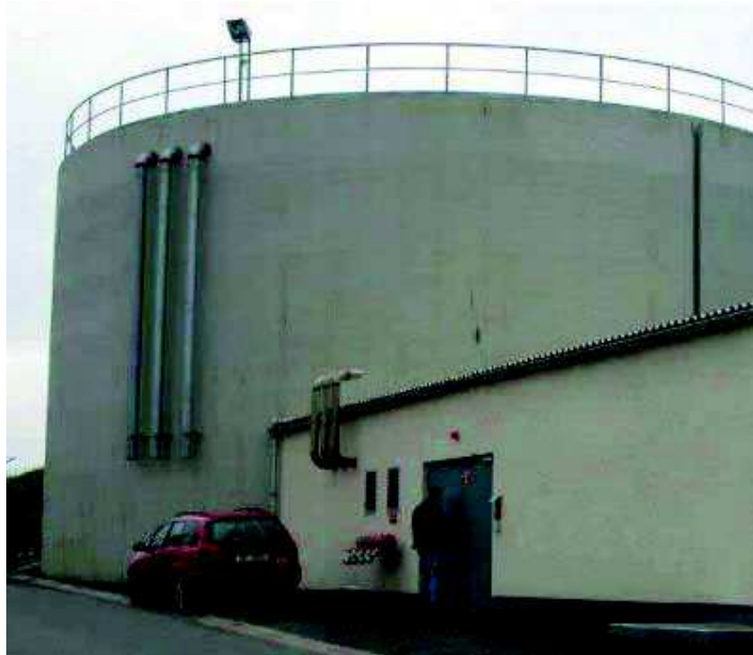
Obrázek 11 Venkovní zásobní nádrž na vodu pro SHZ
