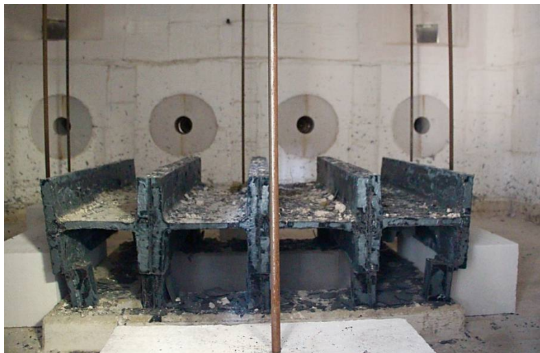
Obr. 23: Otvor v podlaže pece H2 s ochrannou ocelovou konstrukcí
