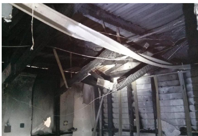
Obrázek 59 - Fotografie selhání vazníku T2 po experimentu (23)
