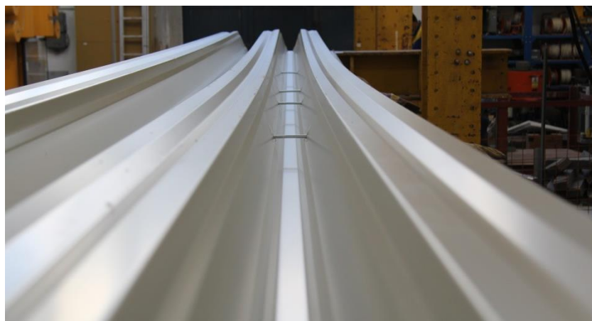
Obrázek 80: Ukázka viditelné deformace trapézového plechu
