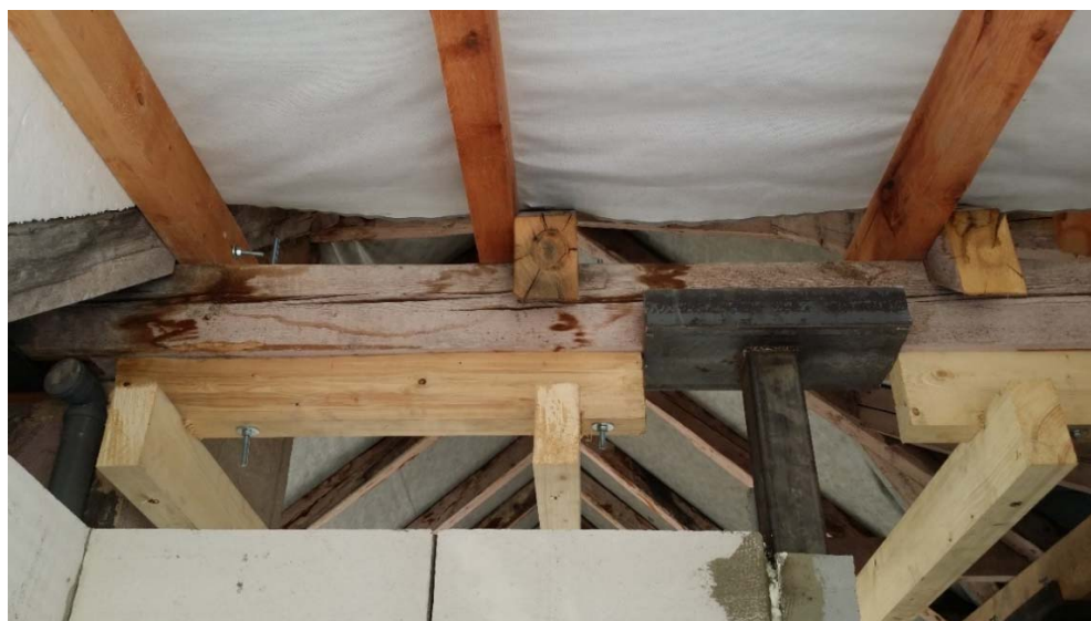
Obrázek 11: Fotografie prostoru kolize vedení vzduchotechniky, pohled z koupelny
