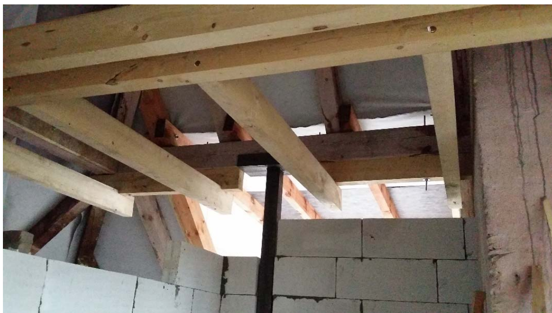
Obrázek 10: Fotografie prostoru kolize vedení vzduchotechniky, pohled z kuchyně
