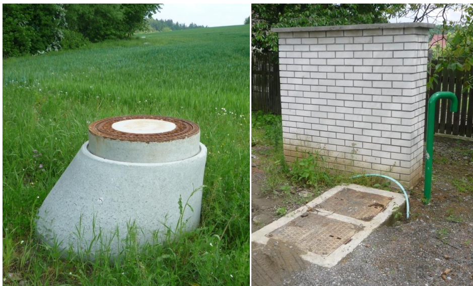
Obrázek 6: Vyvýšené poklopy nad úroveň terénu a větrání čerpací stanice větrací troubou ve Všestarech
