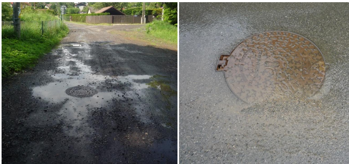
Obrázek 30: Ukázka poklopu osazeného na nevhodném místě a držení se vody na plných poklopech
