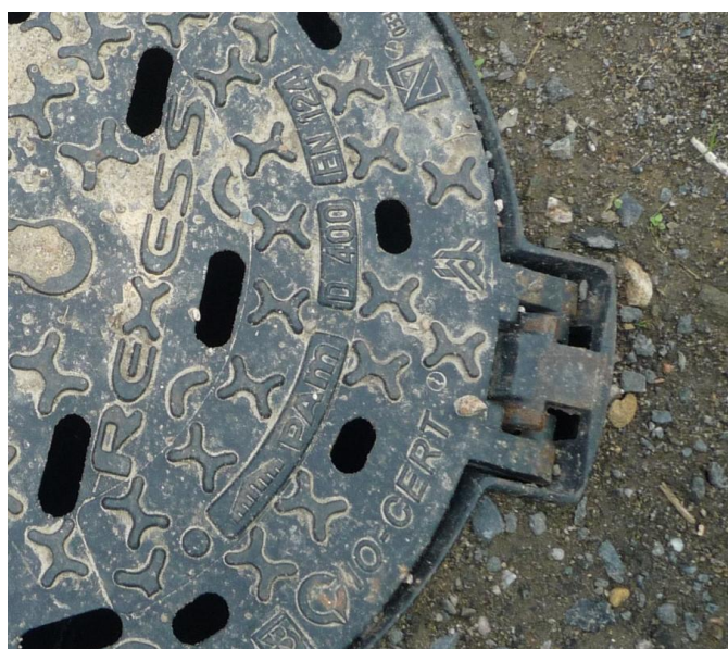
Obrázek 37: Otvor pro kloub, větrací otvory a netěsnosti
