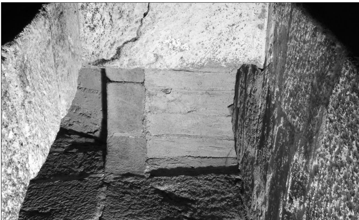
Obr. 28 (vpravo): Svojšín (okr. Tachov), kostel sv. Petra a Pavla. Pohled z prostoru tribuny na prasklý překlad portálu nevhodně zatíženého dosednutím pasu, který vynáší klenbu podesty a stoupavou klenbu nástupního ramene schodiště věže (foto M. Falta 2008).
