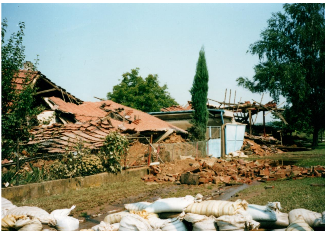
Následky povodně 2002, Foto: vlastní
