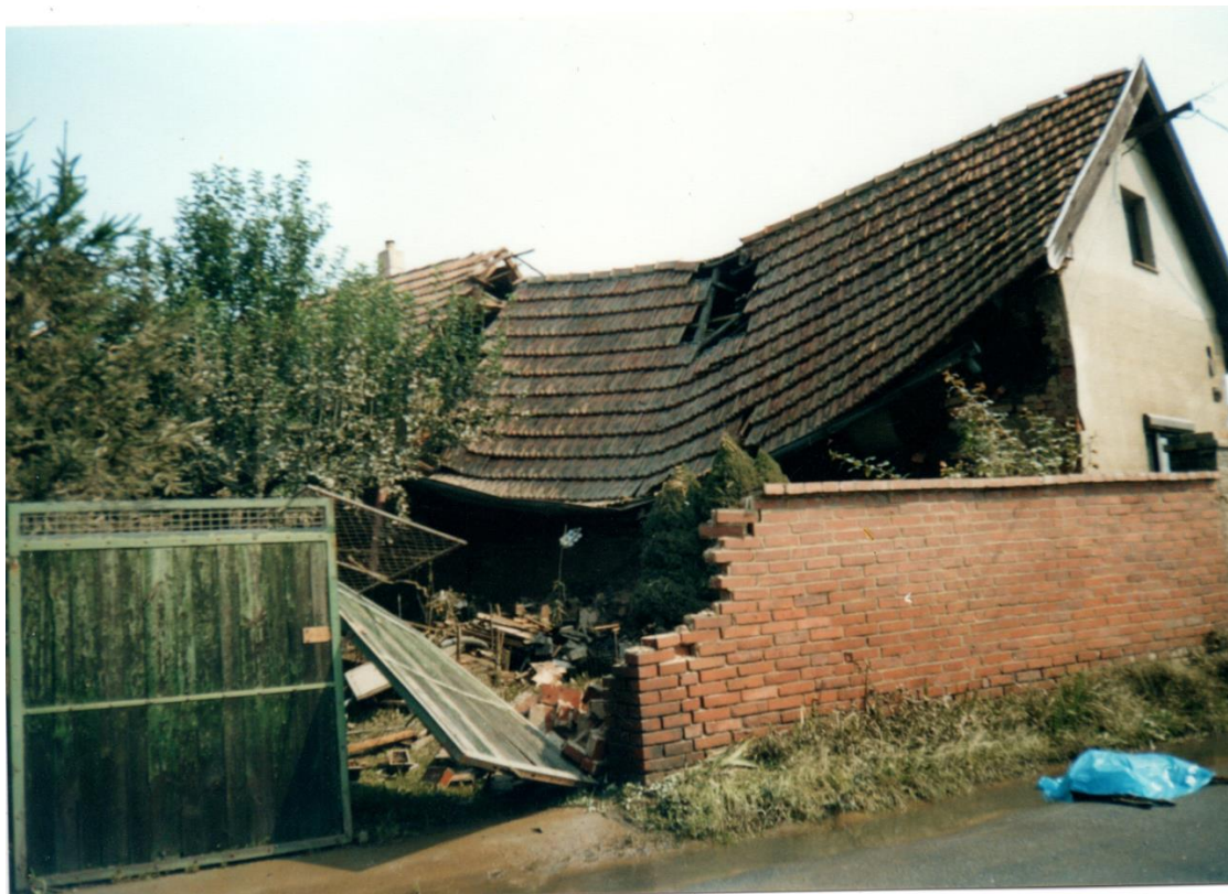
Následky povodně 2002, Foto: vlastní
