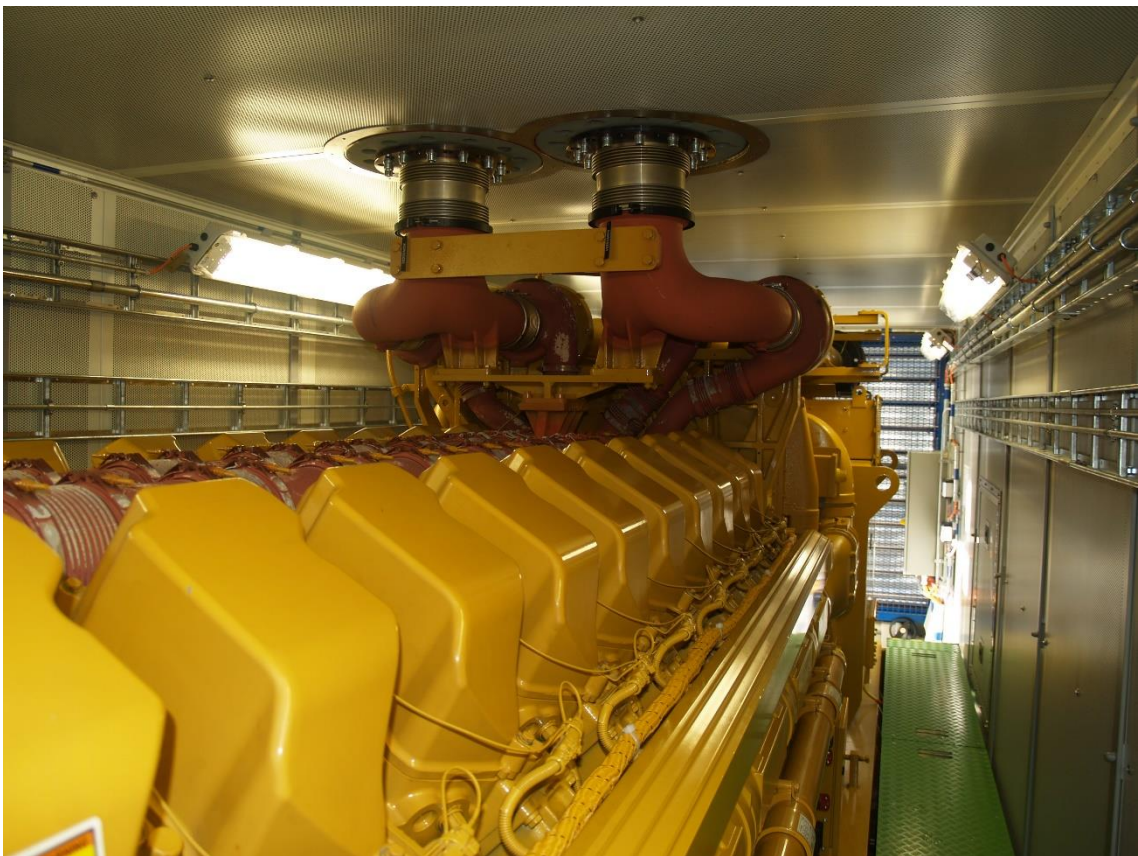
Obrázek 6 - Nově instalovaná station blackout dieselgenerátorová stanice na JE Temelín [36]
