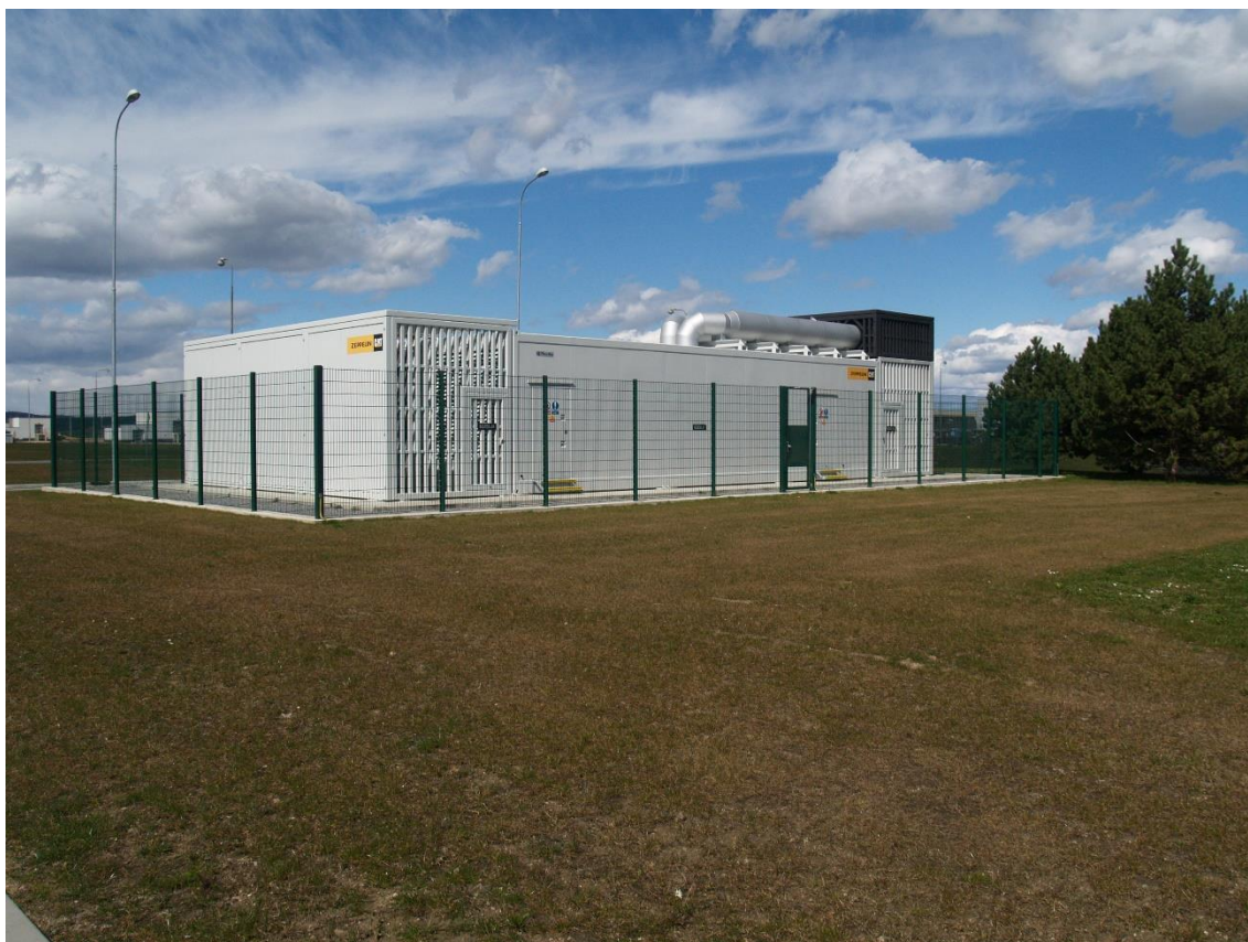
Obrázek 7 - Nově instalovaná station blackout dieselgenerátorová stanice na JE Temelín [36]
