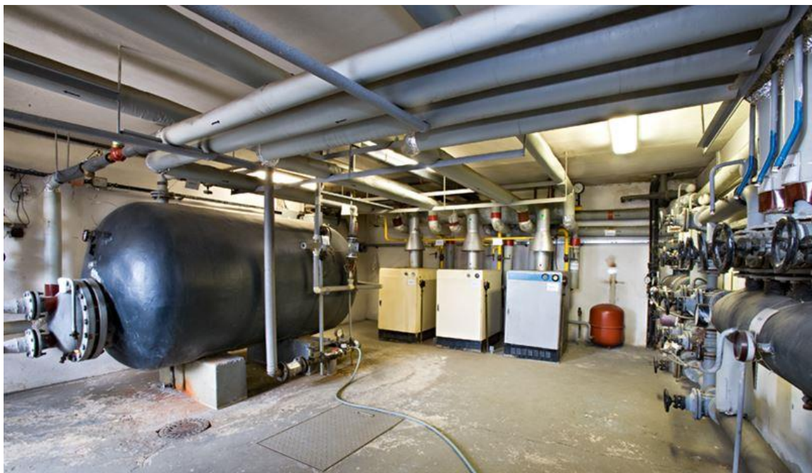
Obr. 4 Původní nevhodná kotelna
