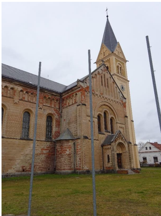
Obr. 2: Opadaná omítková vrstva až na holé zdivo u jihozápadní části křížení lodě a transeptu Vlastní zpracování.
