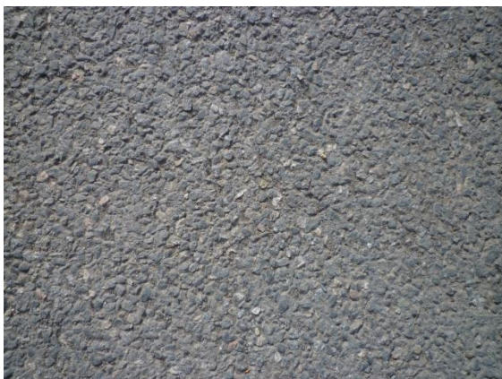
Obrázek 35: Stav asfaltového krytu vozovky.
