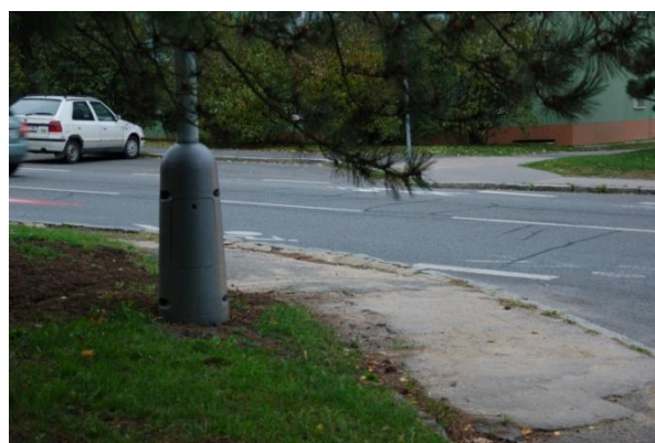
Obrázek 50: Chátrající stav chodníku.
