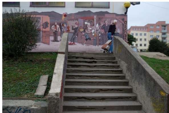
Obrázek 48: Chátrající stav schodů u OC Taškent.
