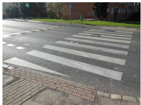
Obrázek 41: Chybně provedené značení přechodu.
