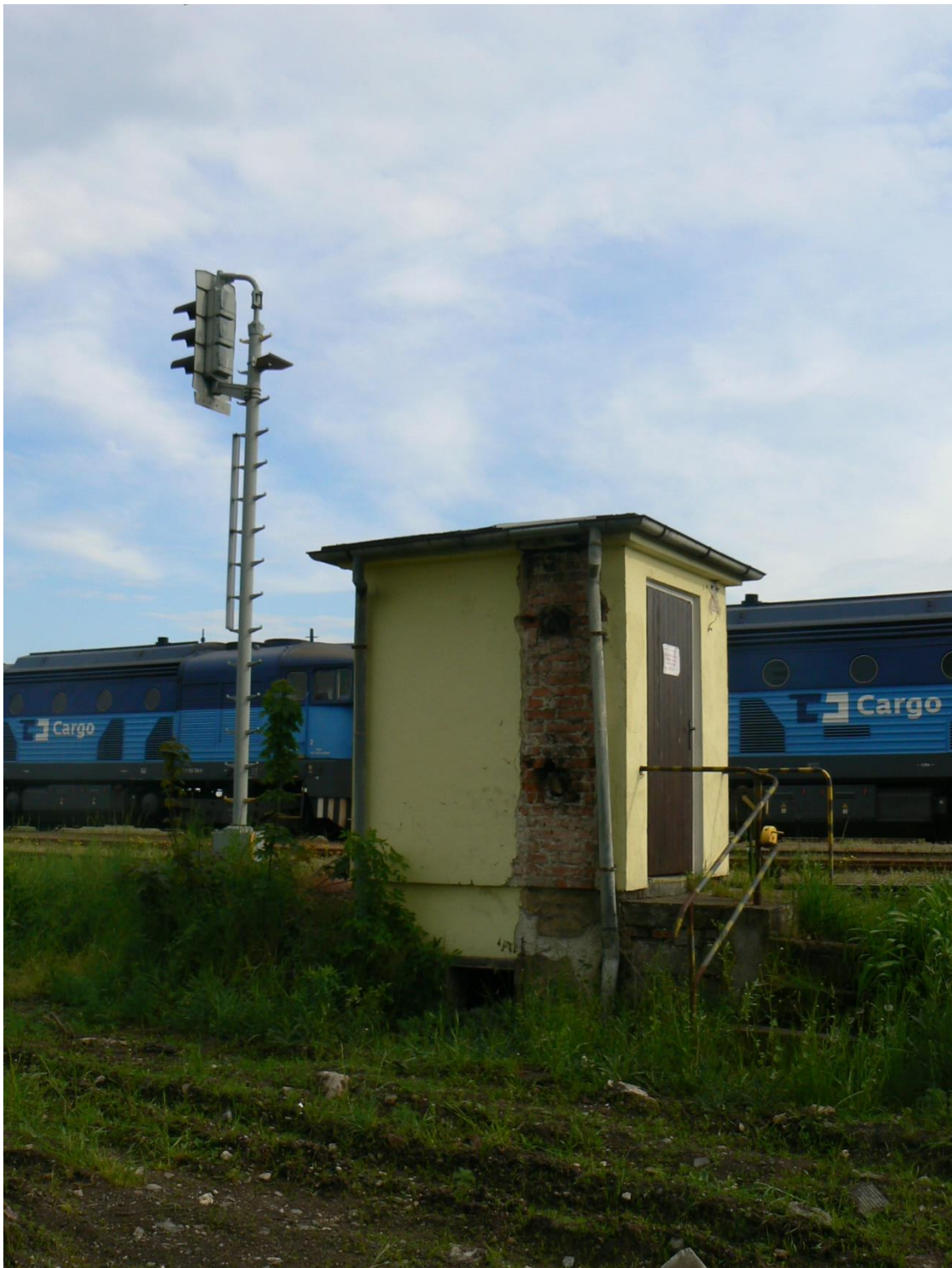
Obr. 30: Pohled na pomocné stavědlo PSt. 2 a odjezdové návěstídko S23
