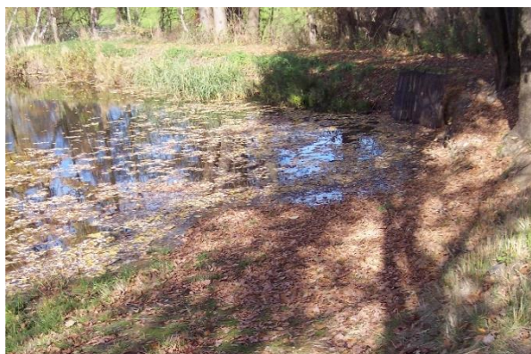
Foto 11: BP MVN Dolního radkovického rybníka - (profil hráze ř. km 0.740). Fotka zobrazuje nátok do BP. BP je tvořen třemi betonovými troubami DN 300. Výtok z BP není nijak opevněný. Odpadní koryto od BP je značně erodované. Nátok do BP je opatřen česlem s hrubostí 2 cm. Dá se předpokládat možné ucpání pouhým listím a ostatním plávím. Z důvodu případného ucpání BP by mohlo následně dojít k přelití hráze
