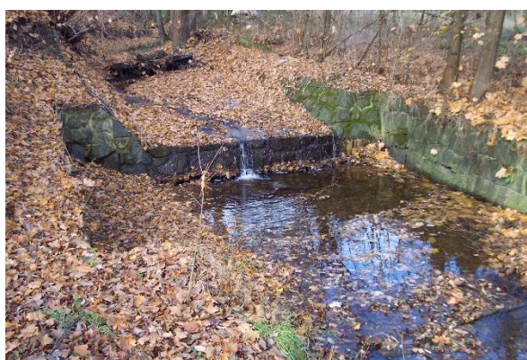
Foto 16: Příčný objekt (stupeň), ř. km 0.443 – Stupeň se nachází v intravilánu obce Nihošovice. Objekt má výšku 1,039 m. Koryto nad objektem je upraveno ochrannými dřevěnými kužely, které tok usměrňují
