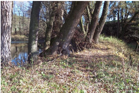
Foto 1: Hráz MVN Dolní turný rybník – hráze MVN se nachází v ř. km 0.360. Pohled na hráze a část zátopy. Na hrázi se nacházejí staré vrby, které jsou často vyvrácené. Hráze je v místě obtokového koryta BP rozrušena. V místě spodní výpusti na vzdušném líci hráze dochází k zpětné erozi kolem trouby výusti
