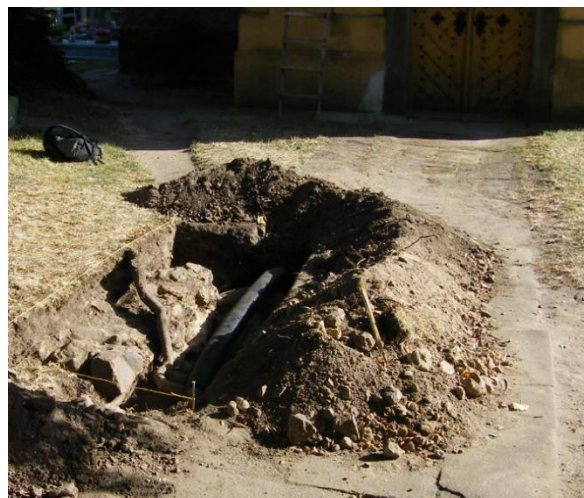
Obr. 19: Poloha elektrického kabelu; Zdroj: Mgr. Hůrka
