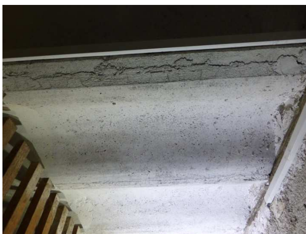
Obr. 2.13: Trhlina v podélné spáře styku stropních panelů ve sklepních prostorech
