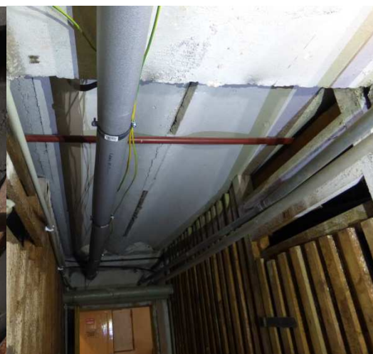
Obr. 2.12: Pohled na poškozený podhled stropní konstrukce PP
