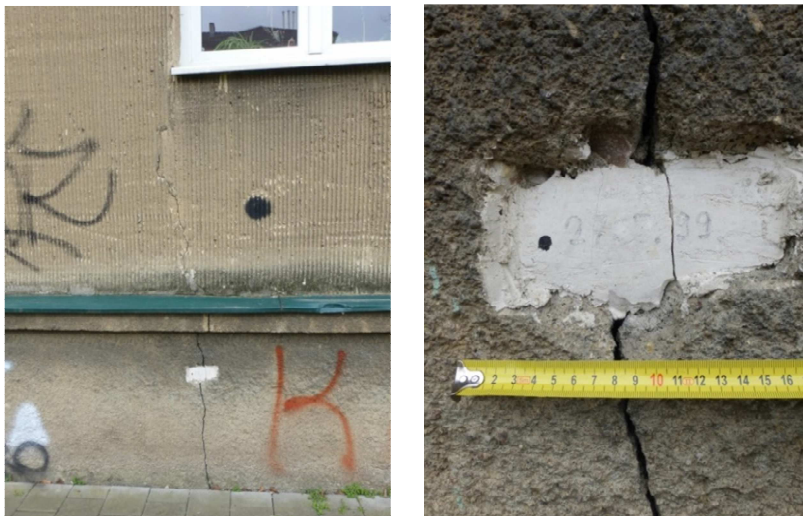
Obr. 2.5: Trhlina T01 - pohled a detail
