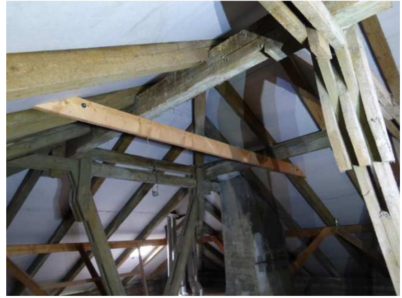
Obr. 2.41: Dodatečné ztužení krokví prázdných vazeb kleštinou, sesychací trhliny na vaznici a krokvích
