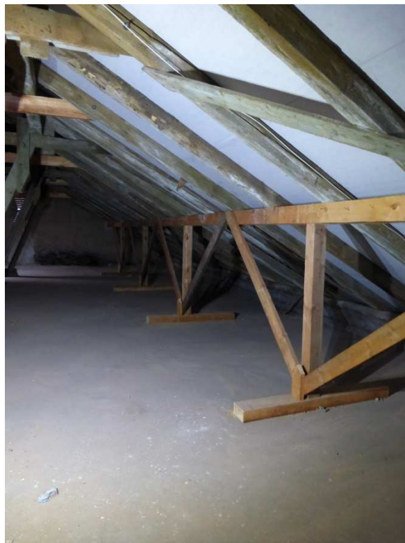
Obr. 2.37: Dodatečné podélné ztužení krokví podepřením krokví přídavnými vaznicemi, podpíranými sloupky s rozpěrami
