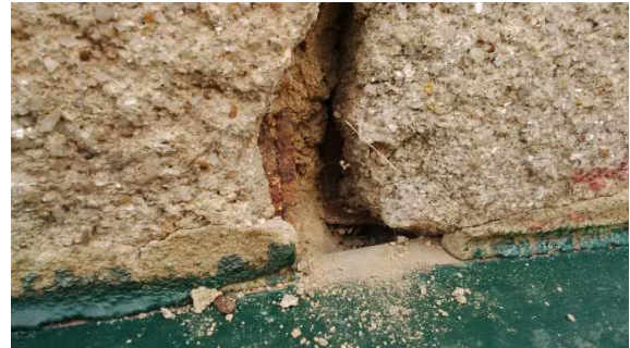
Obr. 2.32: Porušení betonové zálivky a obnažení výztuže mezi fasádními dílci v soklové oblasti
