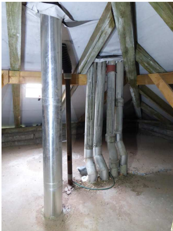
Obr. 2.36: Chybné provedení hydroizolační vrstvy v místech prostupů střešní konstrukcí
