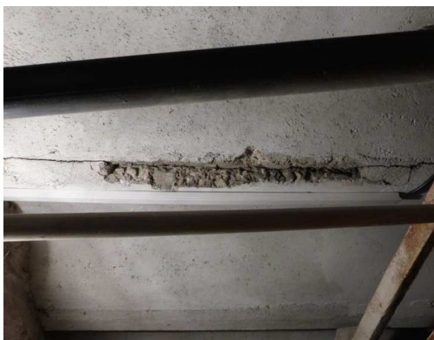
Obr. 2.11: Degradace betonu stropních panelů ve sklepních prostorech
