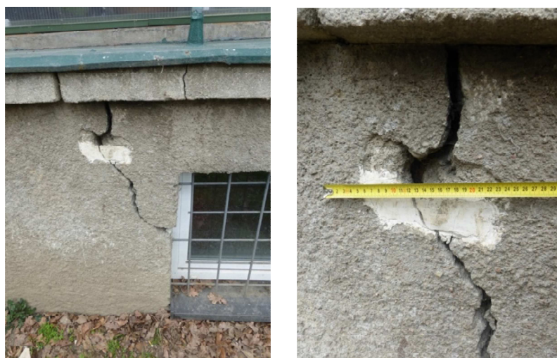
Obr. 2.7: Trhlina T03 - pohled a detail
