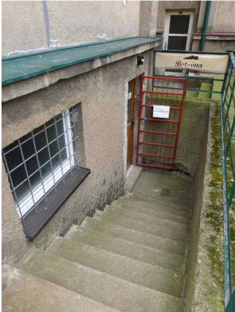
Obr. 2.45: Jednoramenné schodiště přiléhající k severovýchodnímu průčelí objektu, poškození betonové zdi
