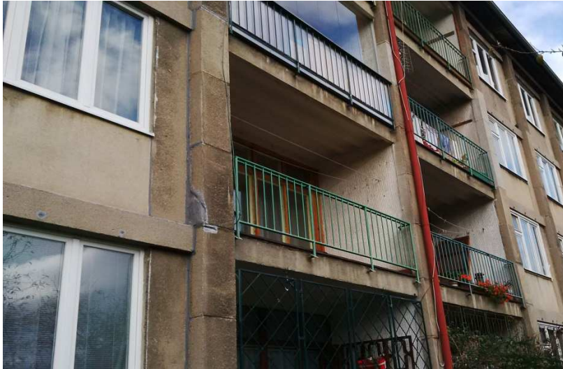
Obr. 2.29: Pohled na lodžie jižního průčelí, utěsnění spar mezi jednotlivými dílci v minulosti, trhliny železobetonových věnců v oblasti lodžii
