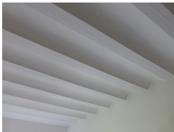
Obr. 2.16: Stropní konstrukce v prostorách hlavního schodiště ve 4.NP sestavená ze stropnic „klenbiček“
