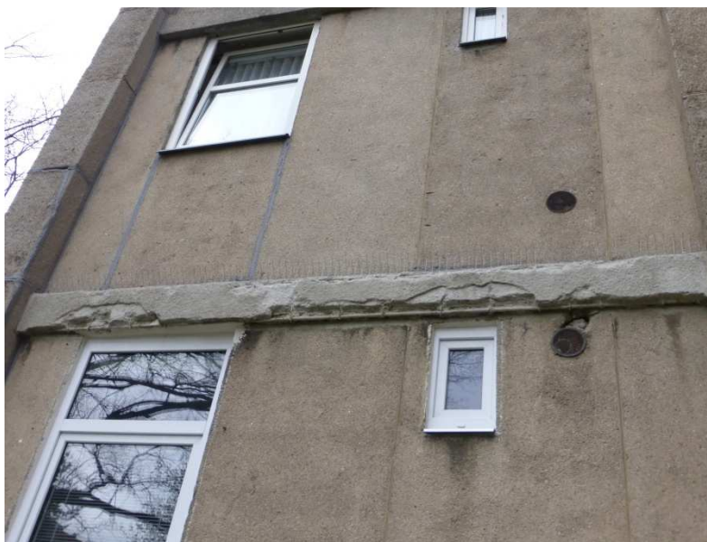
Obr. 2.27: Pohled na porušený železobetonový obvodový věnec na severovýchodní straně fasády
