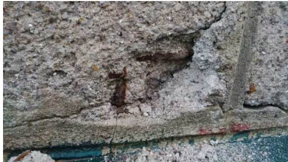
Obr. 2.31: Obnažení výztuže obvodového panelu v soklové oblasti
