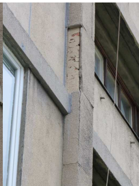
Obr. 2.28: Pohled na porušené a odpadlé tenkostěnné obložení nosných zděných stěn předsazených před líc fasády
