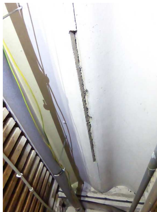
Obr. 2.14: Odpadávání záливkového betonu mezi dvěma stropnicemi
