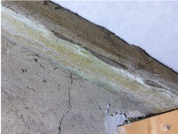
Obr. 2.40: Napadení krokví souvislou plísní
