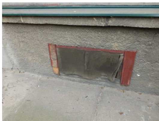
Obr. 2.49: Absence okenní výplně v soklové oblasti na severním průčelí
