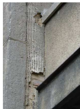
Obr. 2.34: Opadaná rýhovaná omítka na bočních stěnách lodžii a obnažení nosného zdiva
