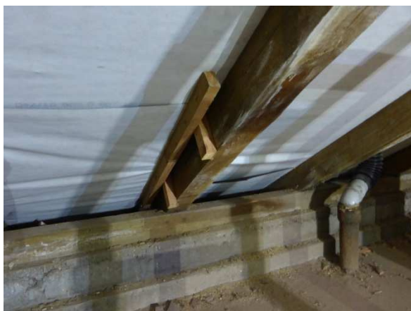
Obr. 2.38: Nekvalitní provedení hydroizolační vrstvy – nedostatečné překrytí, zvlnění
