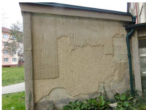
Obr. 2.33: Znehodnocená rýhovaná omítka na stěně vstupního vestibulu na severním průčelí
