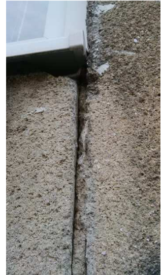
Obr. 2.30: Porušení betonové zálivky mezi dílci v místech parapetu okna
