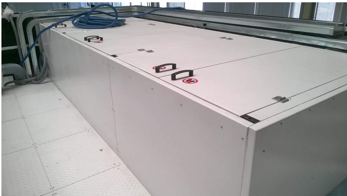
Obr. 14 Pohled na zavřený sušící tunel
