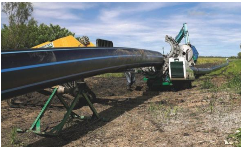
Obr. 2.2 Výměna ocelového vodovodního potrubí za potrubí z PE100 Sunshine coast water project Australia [13]
