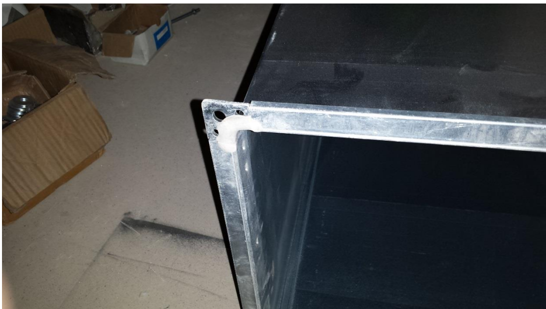
Obr. 6: Příruba čtyřhranného potrubí o šířce 2 cm. (autor Jaroslav Hatoň, 2016)
