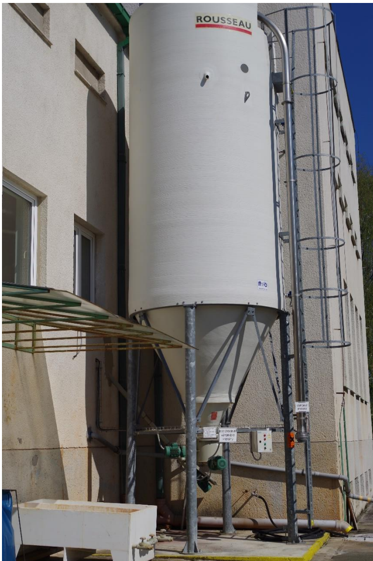
Obr. 3.3. Silo pro uskladnění vápenného hydrátu
