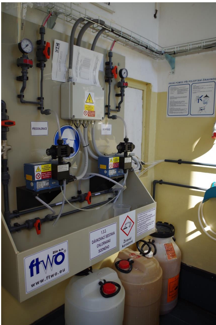
Obr. 3.6. Dávkování chlornanu sodného
