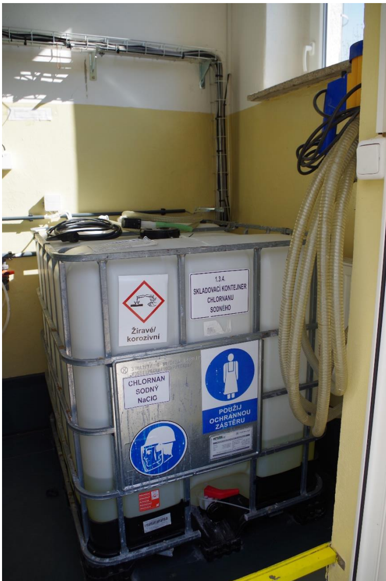
Obr. 3.5. Zásobní nádrž chlornanu sodného
