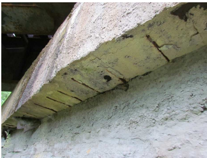
FOTO 14 - Odhalená výztuž na O 01
