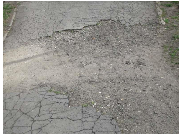
Obr. 69 – Špatný stav pěších komunikací
