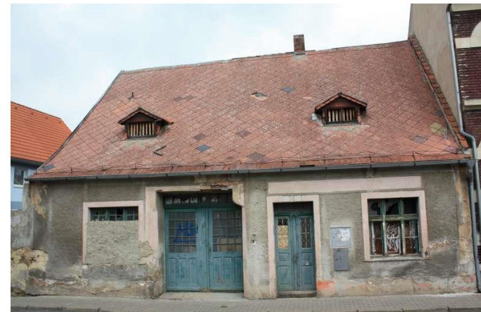
Obr. 64 – Chátrající budova č. p. 451
