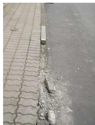
Obr. 36 – Špatný technický stav obrubníku pěší komunikace v Chomutovské ulici
