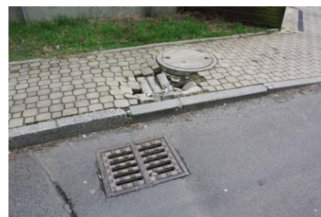
Obr. 37 – Špatný technický stav pěší komunikace v ulici U Stadionu
