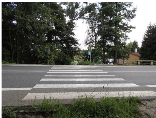
Obrázek 29 - Nevhodně umístěný přechod ústící do silnice ulice Pod Slovany
