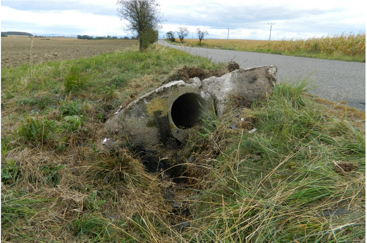
Obr. [35] Porušené betonové čelo propustku po nárazu
