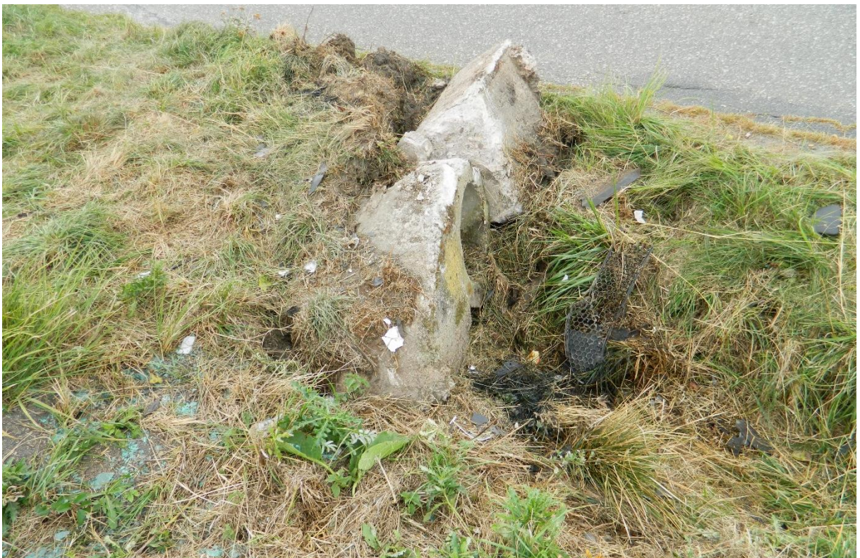
Obr. [34] Porušené betonové čelo propustku po nárazu
