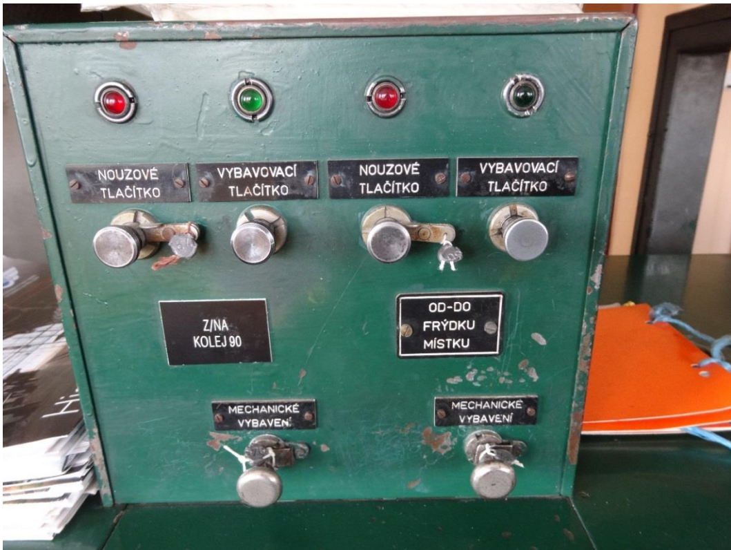
Obr. 20: Tlačítka pro nouzové ovládání elektromechanického SZZ.
