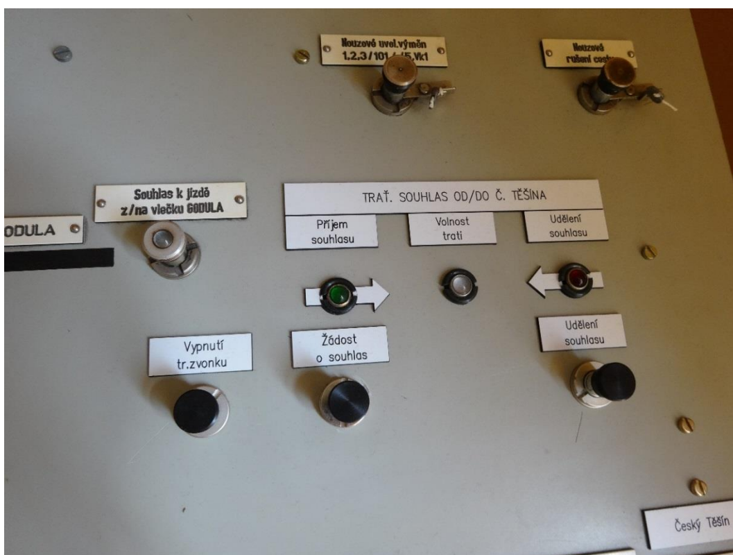
Obr. 10: Detail elektronického stavědla TEST 14 s připravenými prvky pro ovládání automatického hradla.
