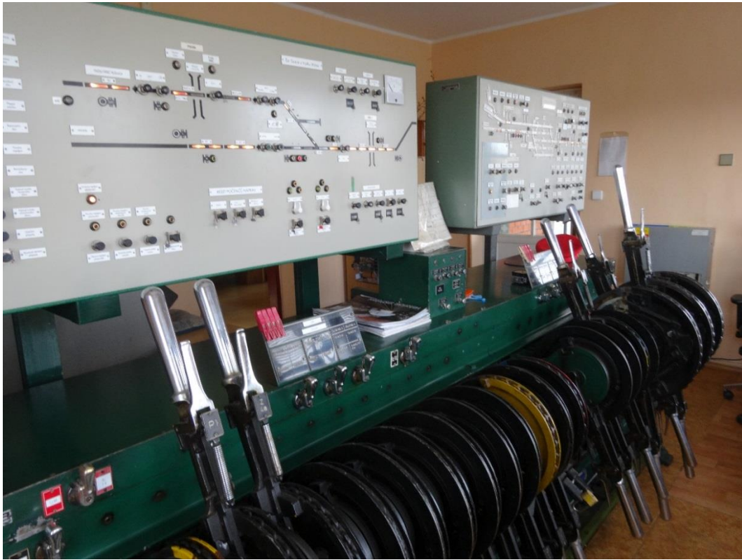
Obr. 17: Ústředí stavědlo ŽST Dobrá u Frýdku-Místku. Vlevo elektronické stavědlo TEST 14, dole páky ovládání výměn, výkolejek a návěstidel elektromechanického SZZ a vpravo jeho indikační deska.
