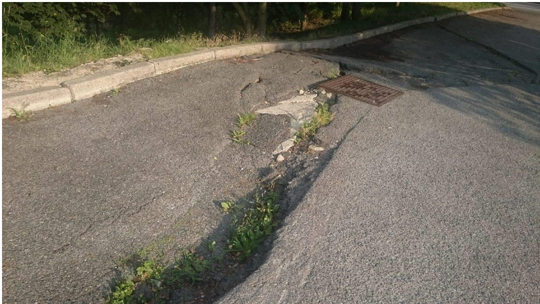
Obrázek 57 - Propadlý terén na parkovišti u ulice Gymnasijní 68
