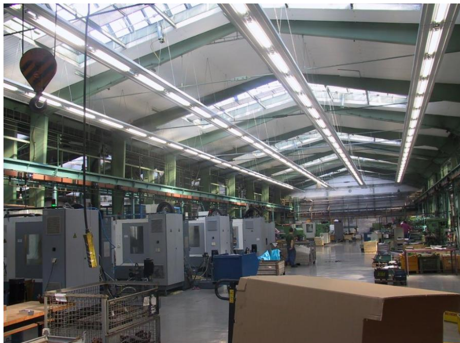
Obr. 7.3 Sálavé panely – výrobní hala Richmont-CZ a.s., Týn nad Vltavou
