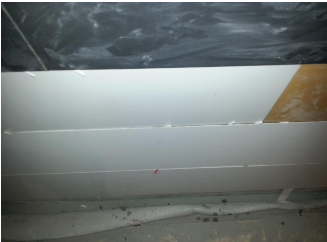
Obr. 41: Nepřesné lepení tenkostěnných obkladů na definitivní ostění přestupní chodby (archiv autora)
