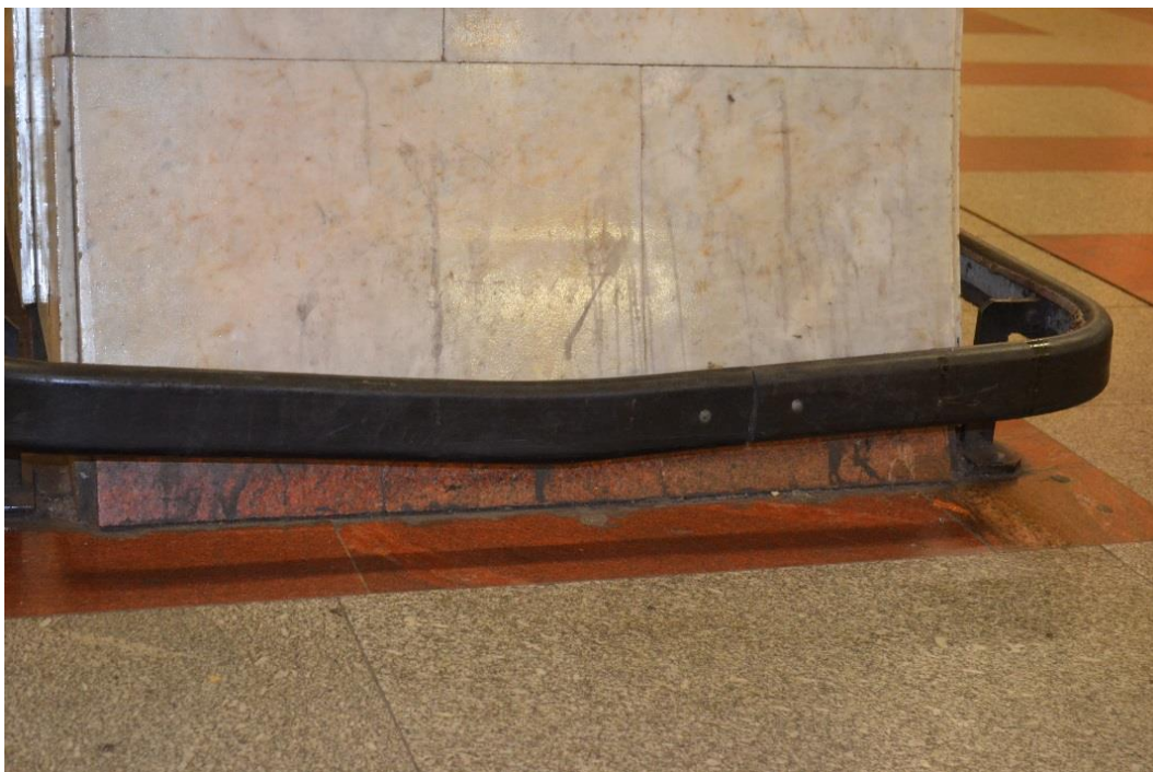
Obr. 18: Poškozené madlo ve stanici před začátkem stavby (archiv autora)
