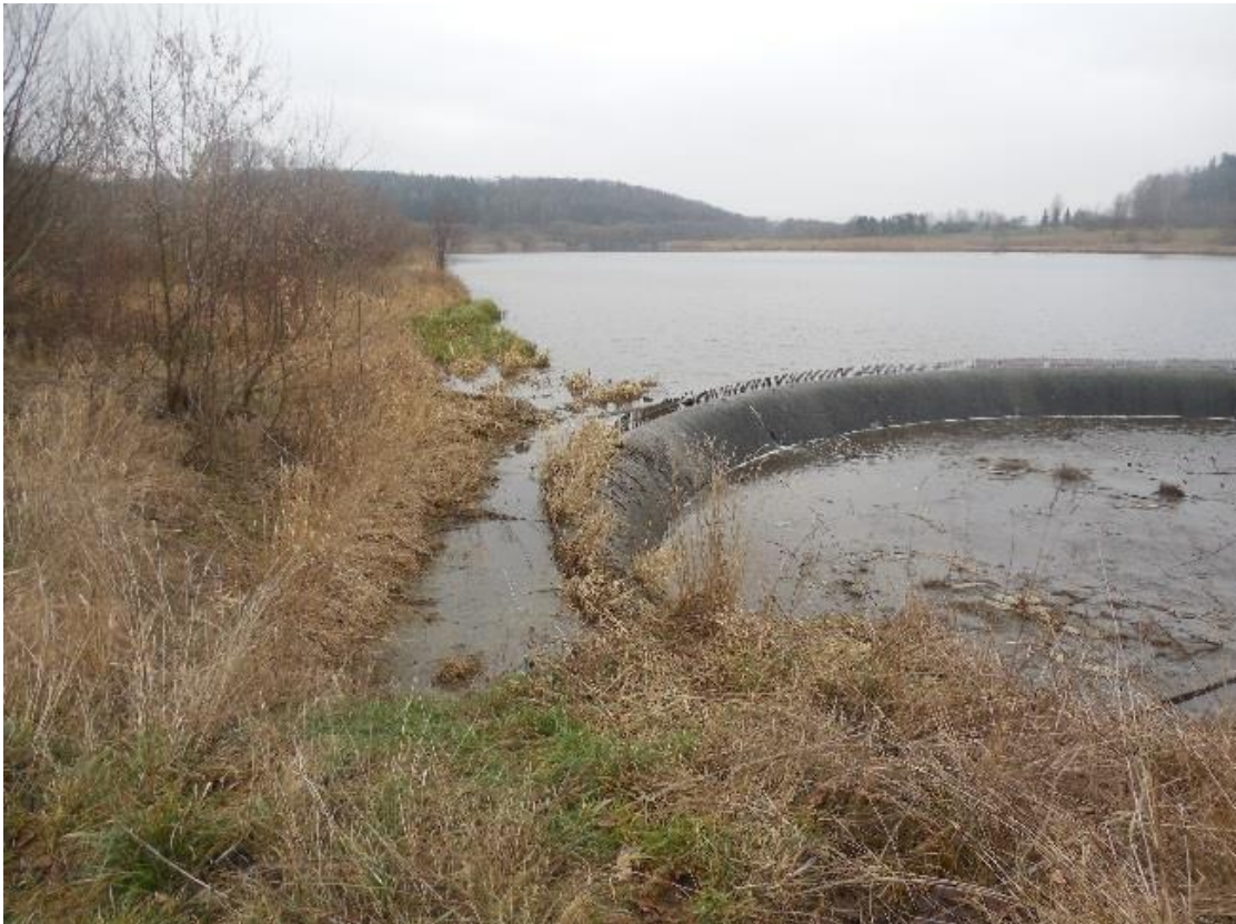
Obr. 11 – Bezpečnostní přeliv – zanesený nátok
