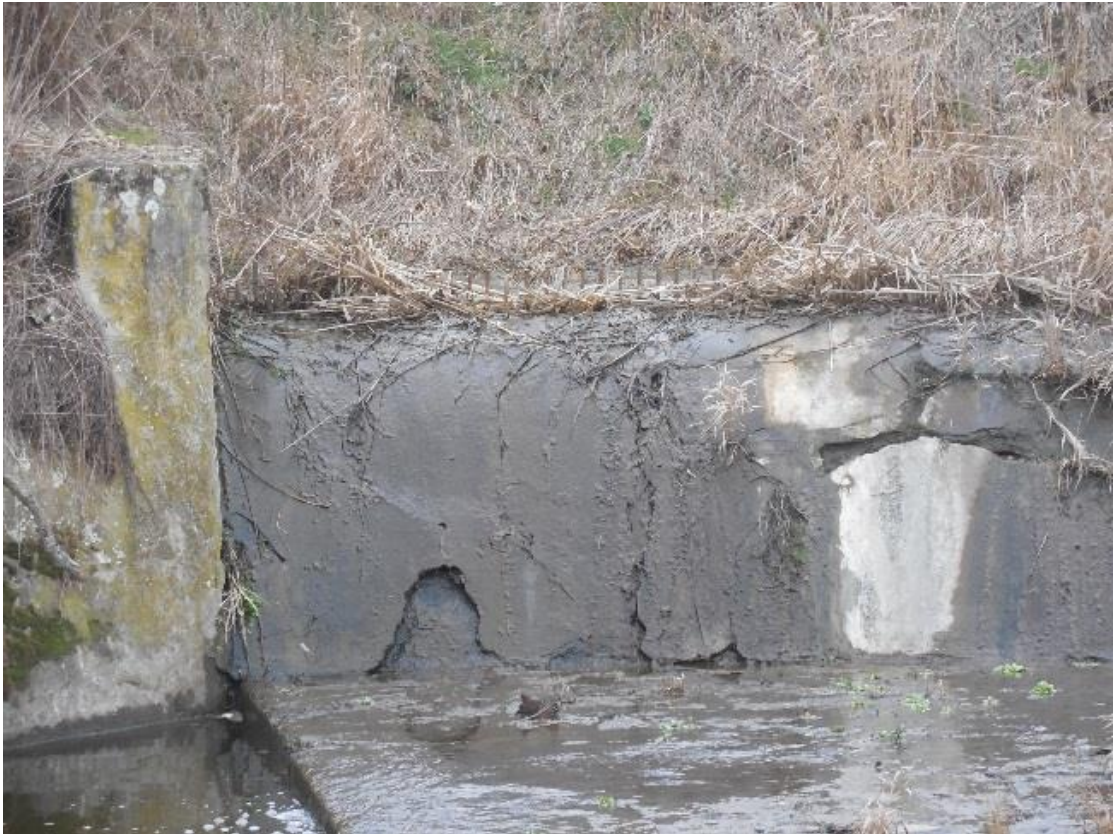
Obr. 12 – Porušené betony přelivné plochy BP
