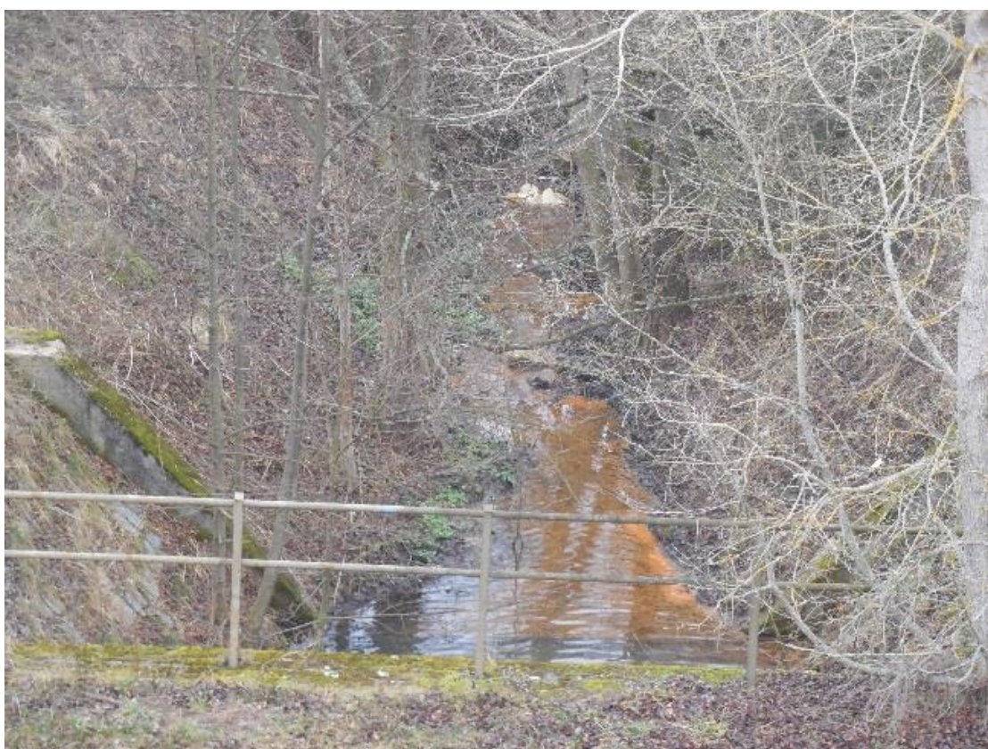
Obr. 25 – Zarostlé koryto pod výtokem z objektů
