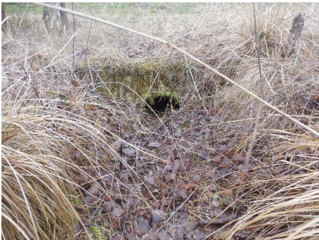
Obr. 24 – Zanesený výtok patního drénu
