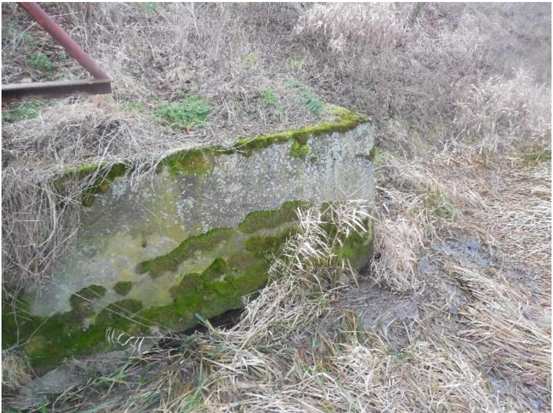
Obr. 15 – Podemletá zeď odpadního koryta
