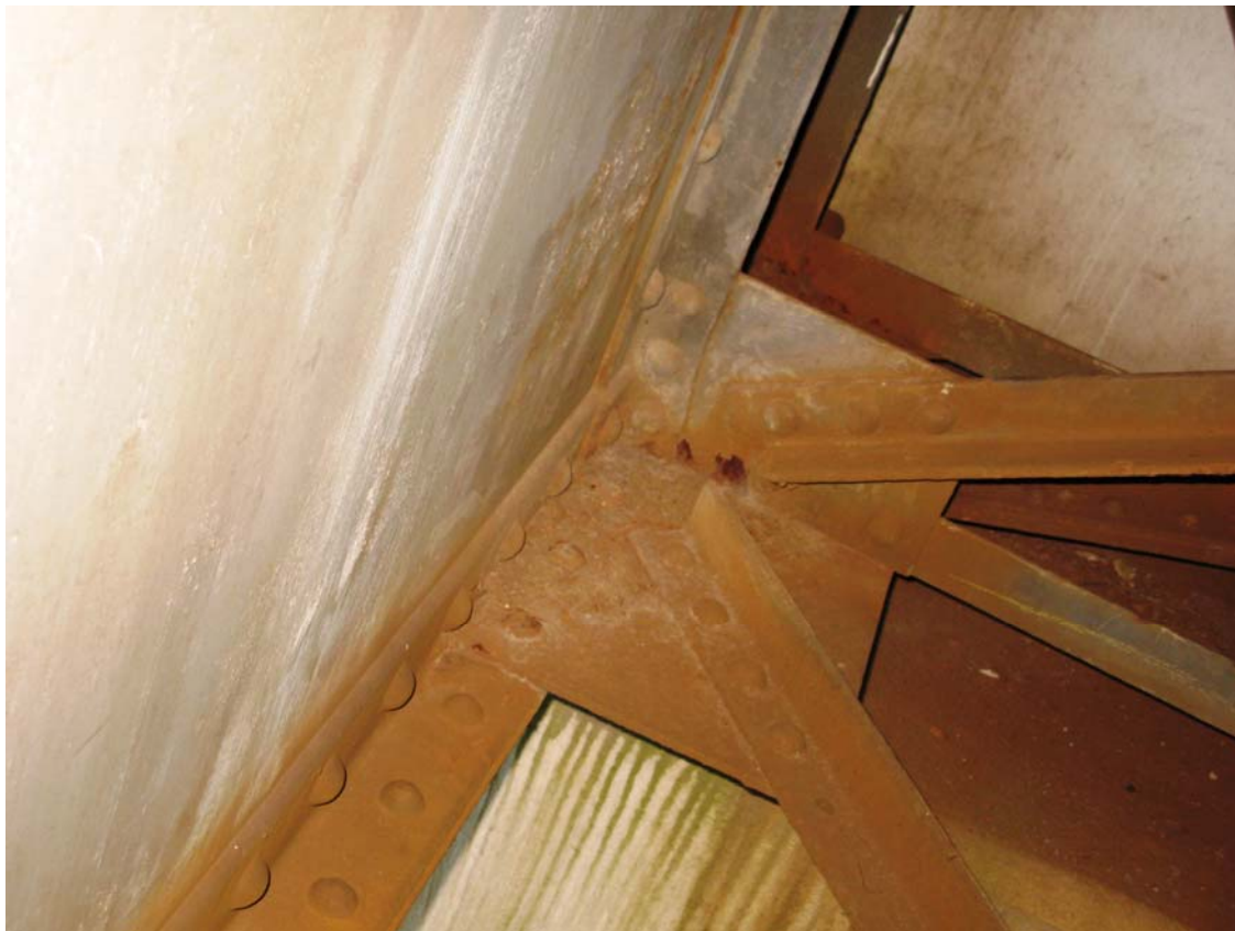
Obr.10 Dolní pásové úhelníky, koroze
