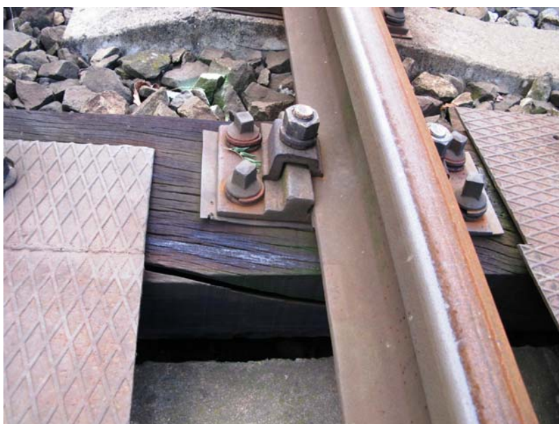
Obr.12 Prasklá pozednice na konci mostní konstrukce
