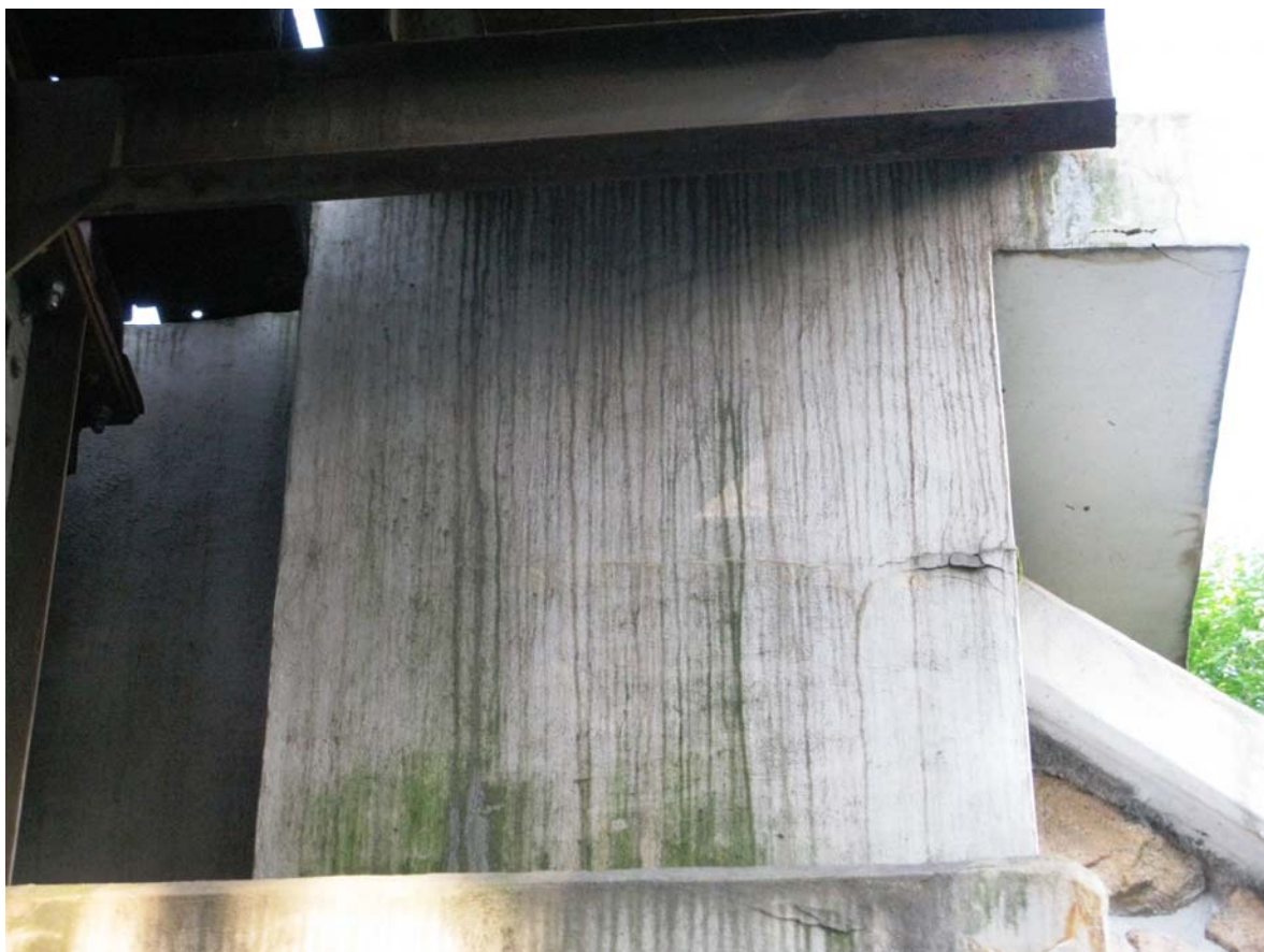
Obr.11 Závěrná zeď, trhlina
