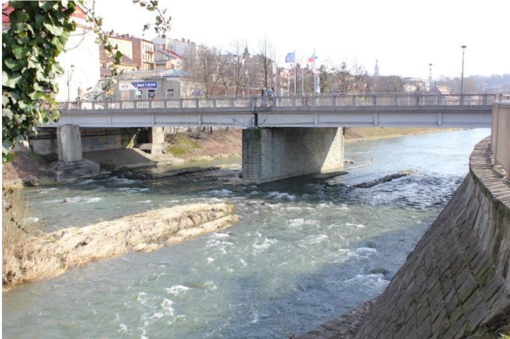
Obr. 13 Pozůstatky pilířů pod silničním mostem (ř. km 37.174), pohled proti vodě
