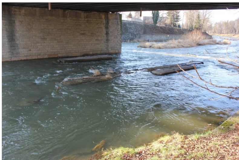
Foto 7 Pozůstatky pilířů pod silničním mostem ř. km 37.174
