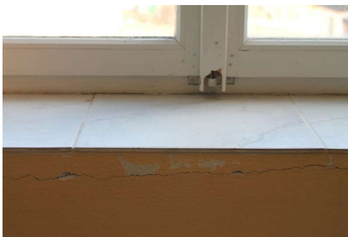
Obrázok 14 Trhlina v omietke pod oknom [3]
