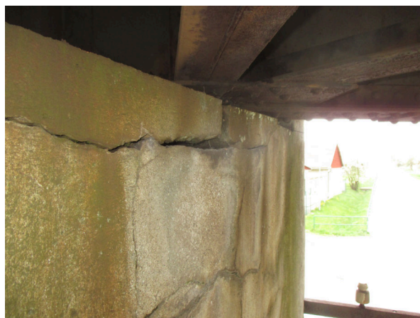
Obr. 2.12: Prasknutá vrstva hornej plochy úložného prahu
