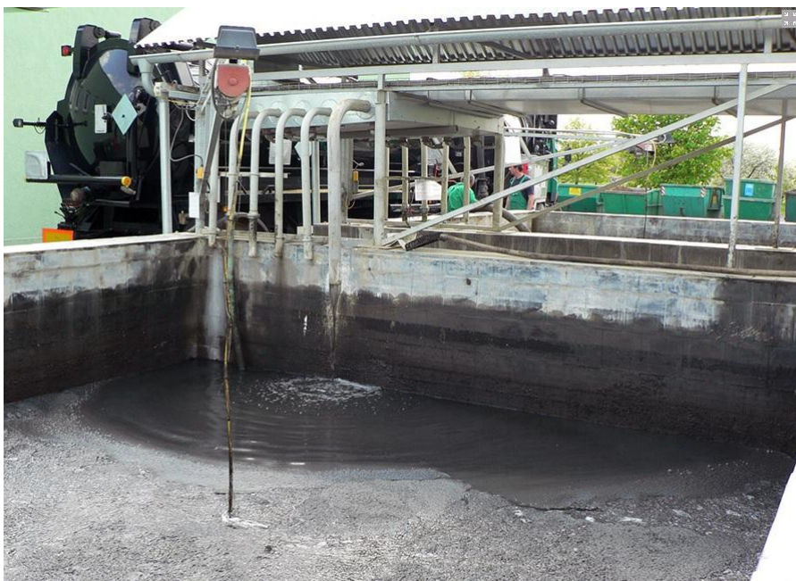
Obrázek 2 - Prostor linky na čištění zaolejovaných vod, reakční jímky [1]
