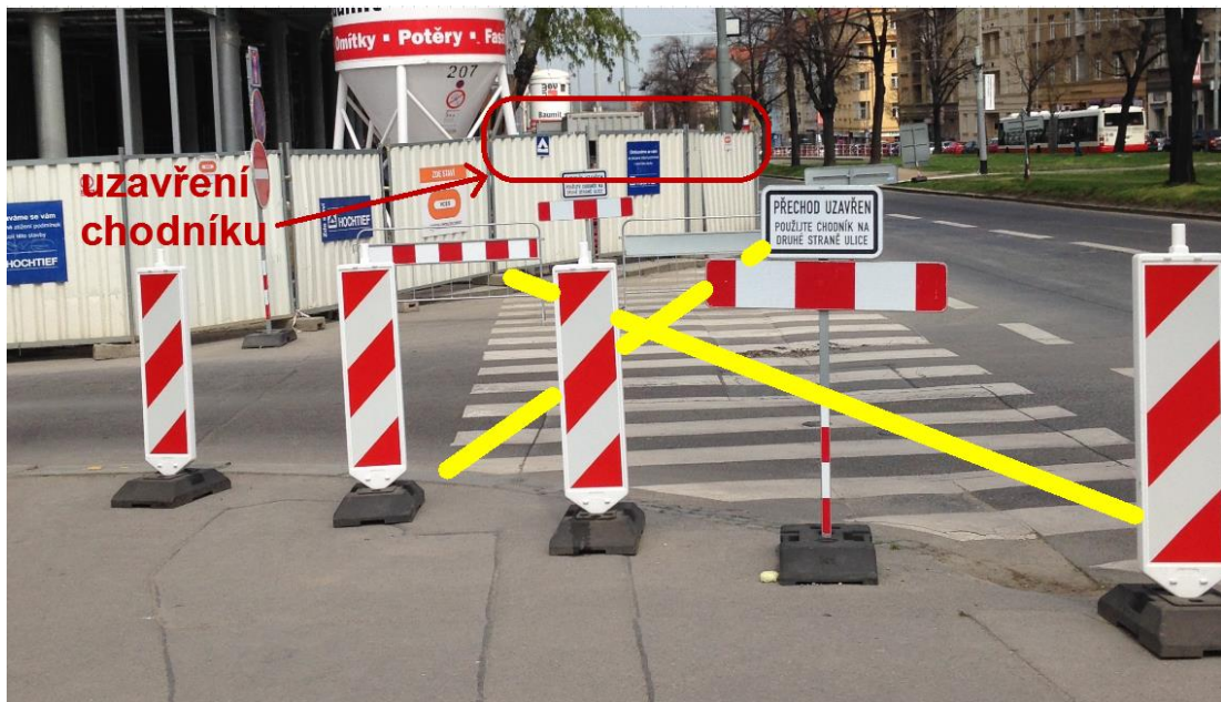
Obrázek 15 – uzavření přechodu a chodníku (archiv autora)
