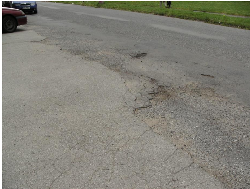
Obrázek 49. Ukázka stavu vozovky u městského stadionu.
