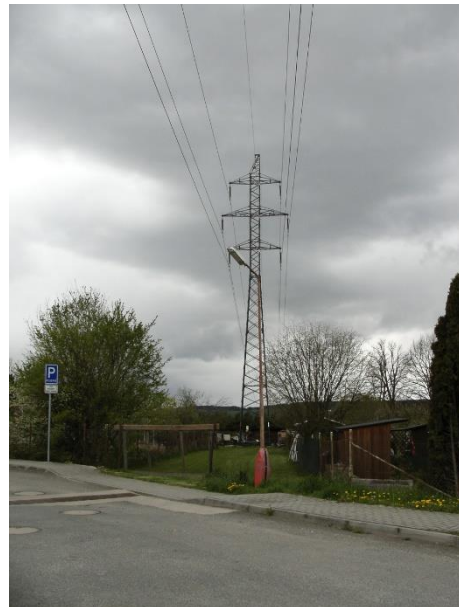
Obrázek 58. Nadzemní elektrické vedení v zahradkářské oblasti.
