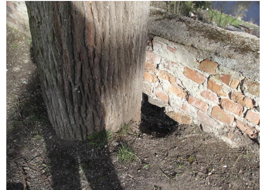
Obrázek 67. Strom vytlačující zídku.
