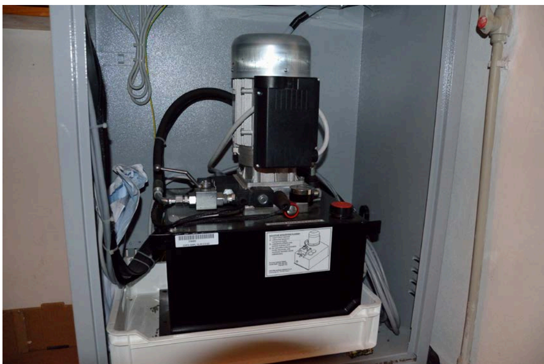
Obr. 7 - Elektro-hydraulická centrála pro pohon zdvižné plošiny [Vytvořeno autorem]
