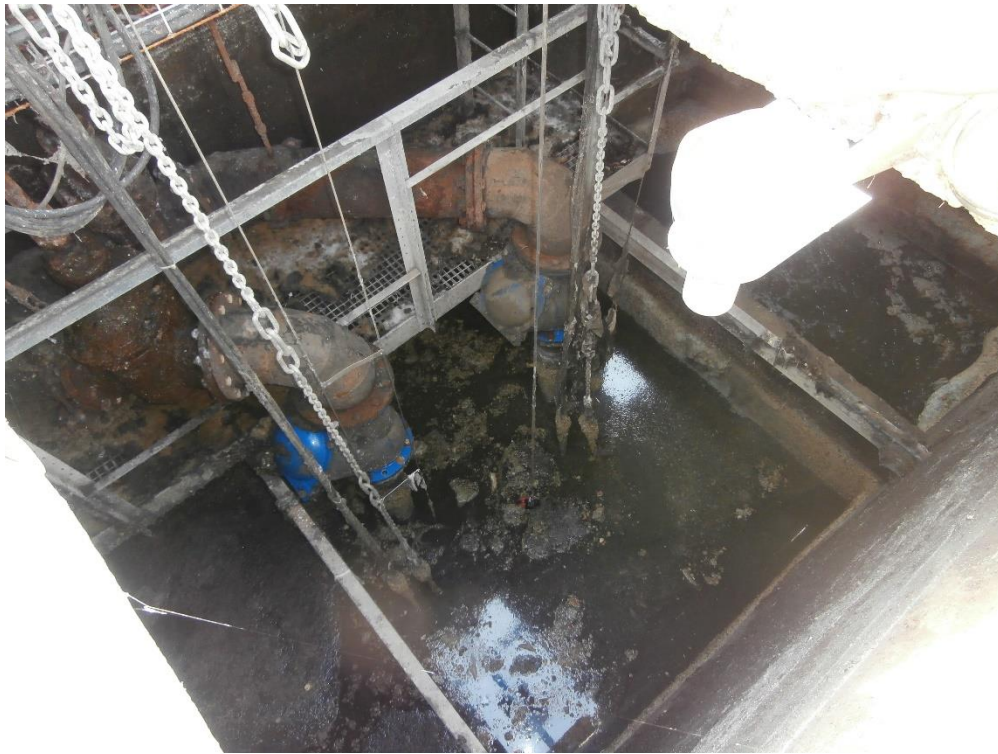
Obr. 15 Pohled na čerpadla v čerpací jímnice
