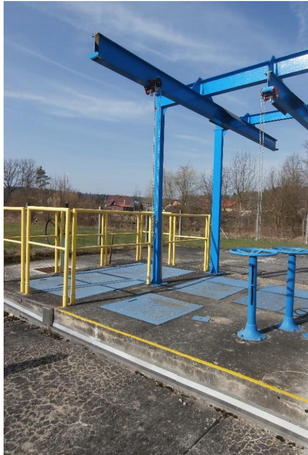
Obr. 13 Čerpací stanice s konstrukcí pro zvedání čerpadel
