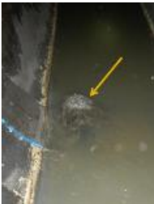
Obr. 5 Zanesení průtokoměru nečistotami [11]
