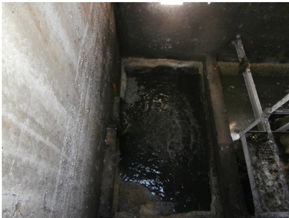
Obr. 14 Nátok do čerpací jímky
