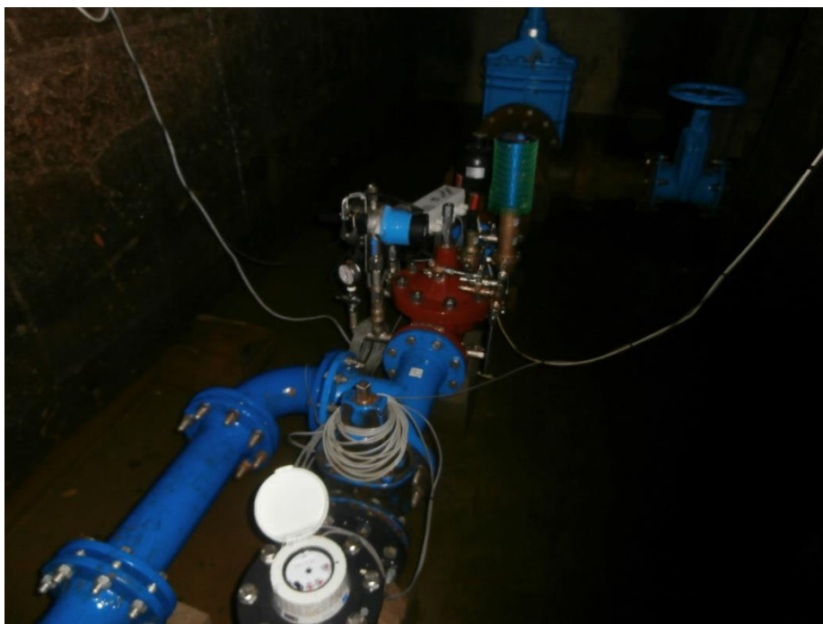
Obr. 25 Vodoměrná sestava včetně redukčního ventilu na přípojce z dálkového řadu – ulice Chýnovská
