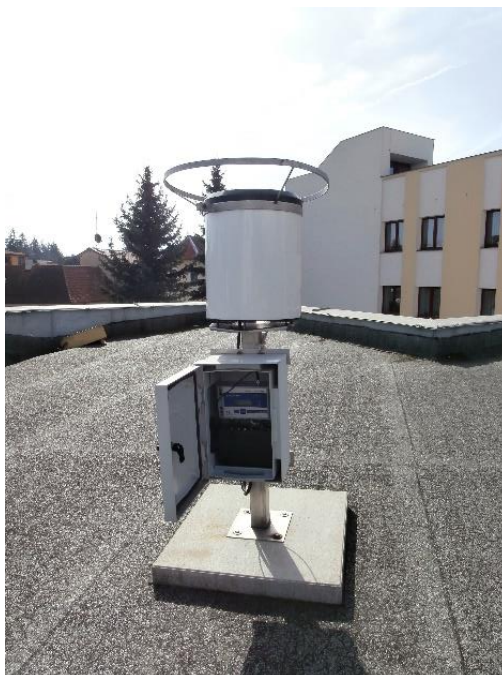
Obr. 22 Umístění srážkoměru na střeše včetně řídicí jednotky
