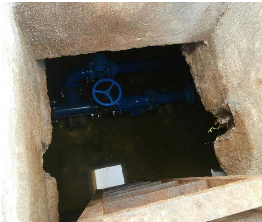
Obr. 24 Šachta na vodovodní přípojce v ulici Chýnovská
